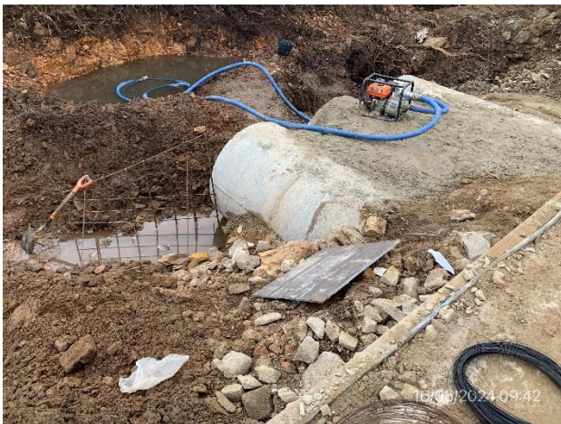
Foto 12.2-7, P04. Motobomba sin elementos de contención para prevenir derrames. Hay residuos dispersos, no hay infraestructura para acopio temporal de residuos.
