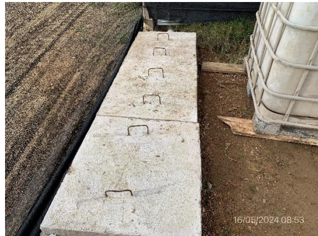
Foto 12.1-6, P03. Obrador, Depósito impermeable para retención de aguas servidas.
