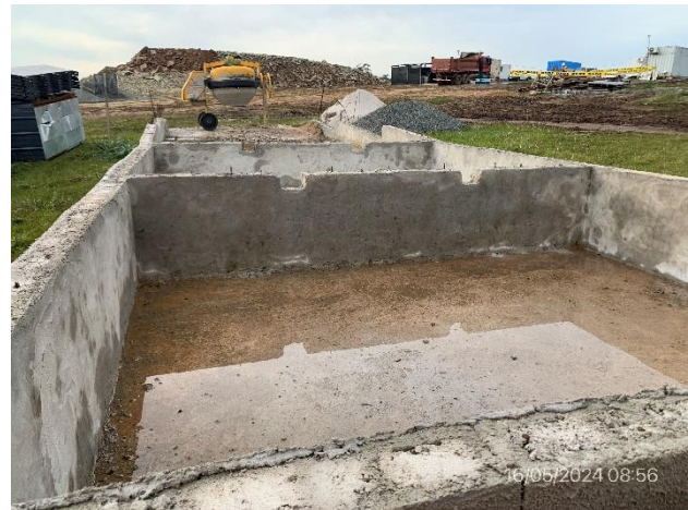
Foto 12.1-8, P03. Obrador, pileta de decantación de aguas de lavado de camiones mixer. Buenas condiciones de limpieza.
