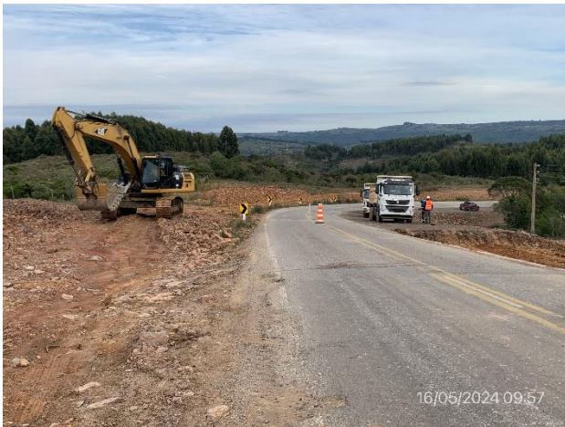
Foto 12.2-9, P05. Frente de obra. Ruta 12 progresiva 355K500. Desmante a terraplén en ejecución.
