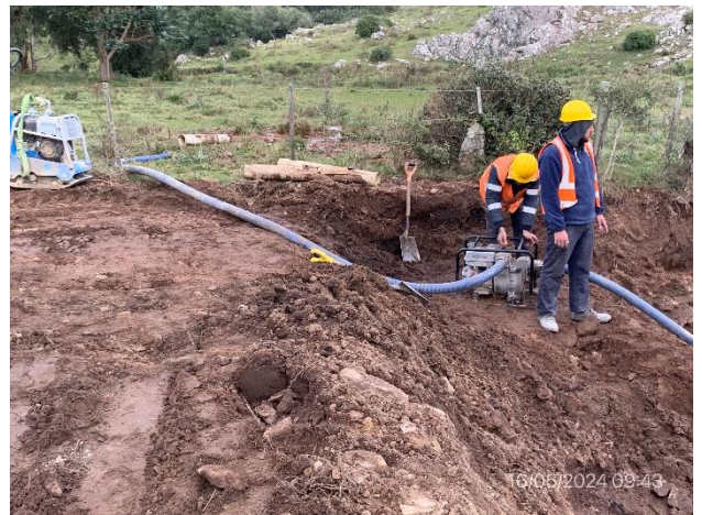
Foto 12.2-8, P04. sin elementos de contención para prevenir derrames. Operarios cuentan con servicios de bienestar incompletos.
