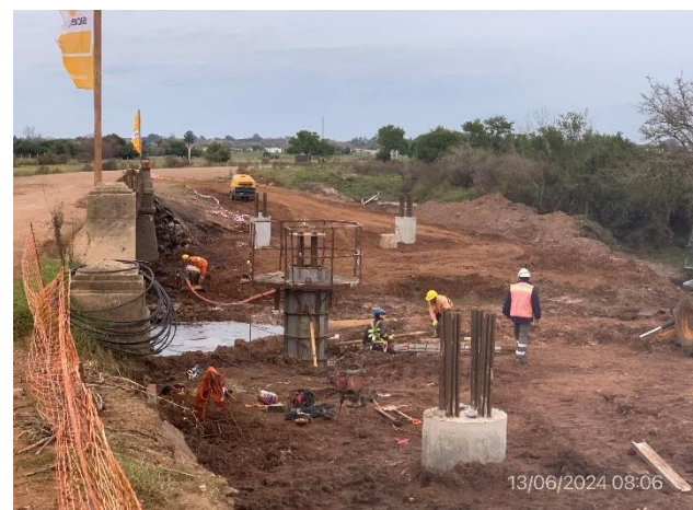
Foto 12.2-2, P01. No hay infraestructura a pie de obra para gestión segregada de residuos acorde a PGA de la obra.
