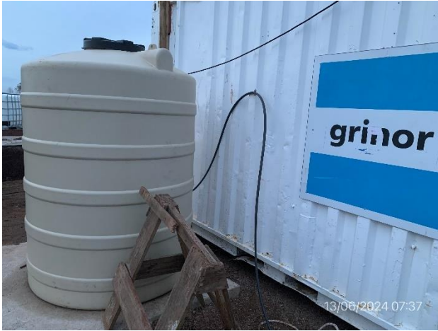
Foto 12.1-7, P02. Tanque de agua potable.
