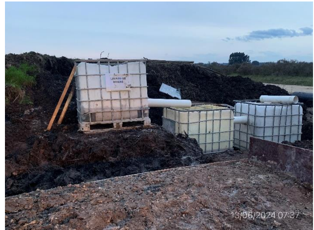
Foto 12.1-4, P02. Planta de lavado de camiones mixer.
