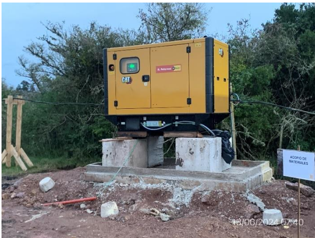
Foto 12.1-9, P02. Generador eléctrico sobre superficie impermeable y envallada..
