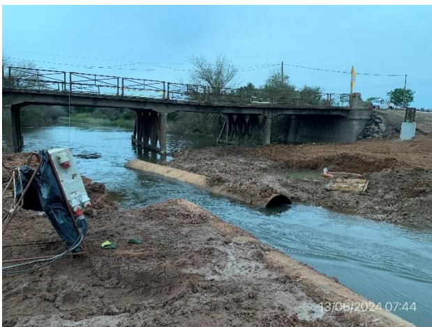
Foto 12.2-5, P01. Puente existente a ser demolido tras la finalización de las obras del nuevo puente.
