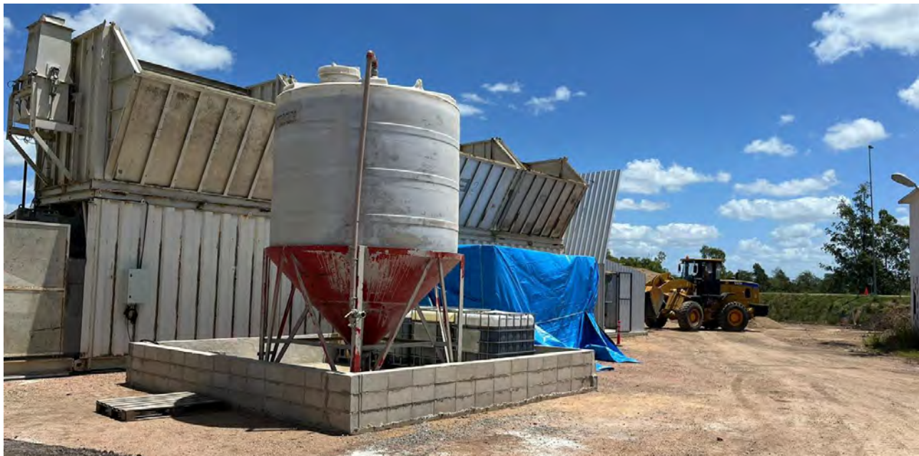
Dique de contención se aditivos de hormigón
