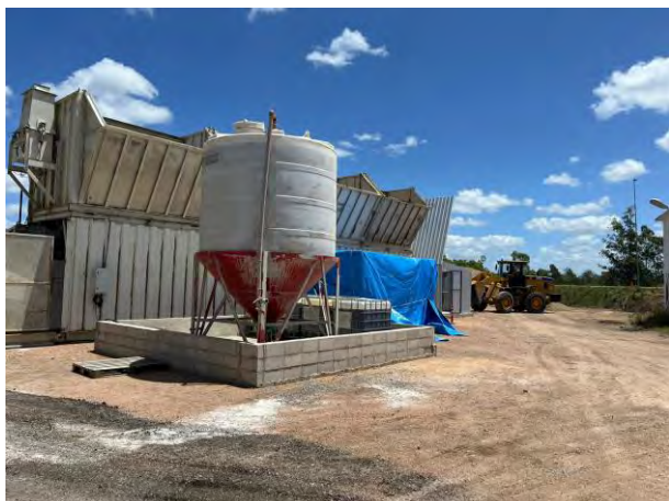
Deposito de aditivos Cabina de operación
