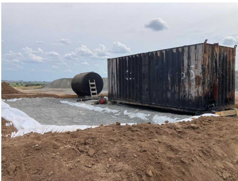
Imagen N° 5 y 6: Contención para los tanques de emulsión y MC 1.
