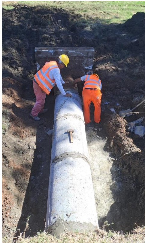
Imagen N°8: Alargue de alcantarilla.
