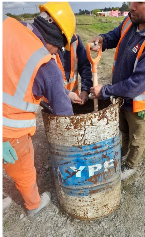
Imagen N°10: Lavado de herramientas en contacto con hormigón.
