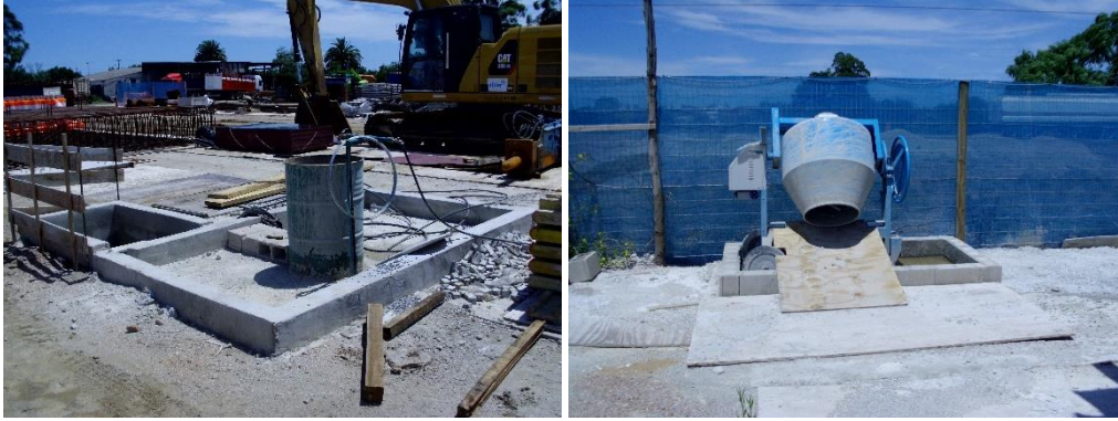
Figura 3-10 Sistemas de lavado y tratamiento efluente de hormigón en obra.
