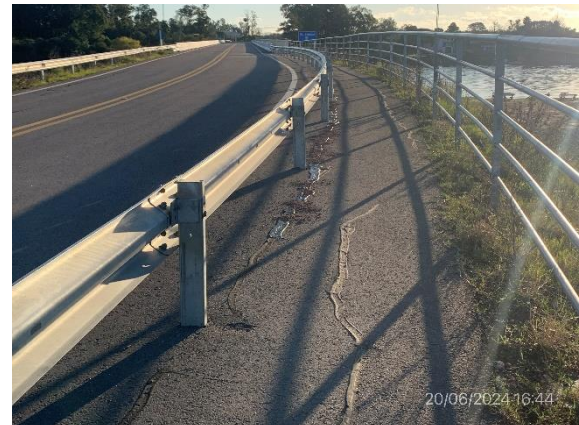
Foto 12.1-10. P01 Carpeta asfáltica con sellado de fisuras por puenteo.
