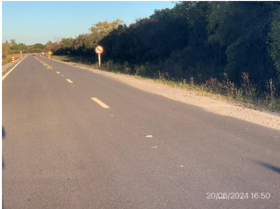
Foto 12.1-7. P01 Acceso Este terminados, abierto al tránsito y con señalización horizontal oculta bajo sedimentos de última creciente.
