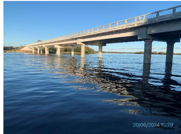
Foto 12.1-4. P01. Cauce del río Cebollatí limpio, sin ROCs en el lecho del río. El Jack – Up fue íntegramente removido.
