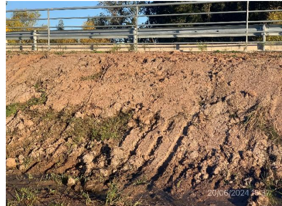
Foto 12.1-8. P01 Talud de terraplen de acceso Este de Ruta 17 a (+) con señales de erosión.
