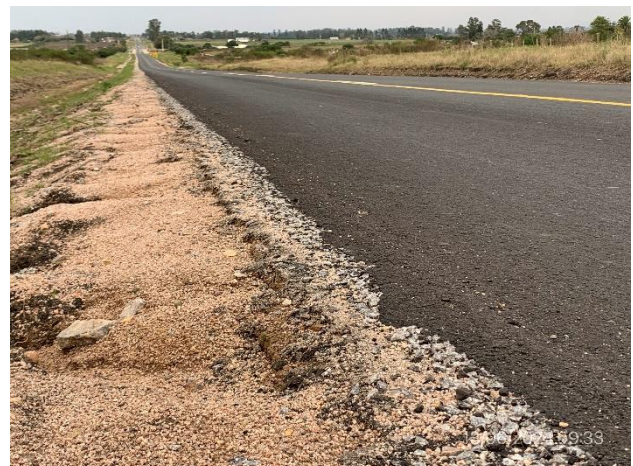
Foto 12.1-6. Calzada de Ruta 63 con sector descalzado, falta de perfilado y compactación. Senda a (-).
