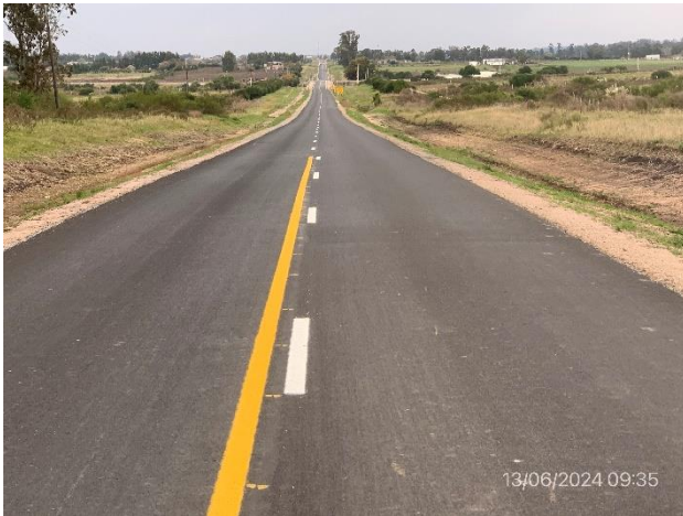
Foto 12.1-3. Obras terminadas en Ruta 63, nueva carpeta de rodadura y señalización horizontal terminadas.
