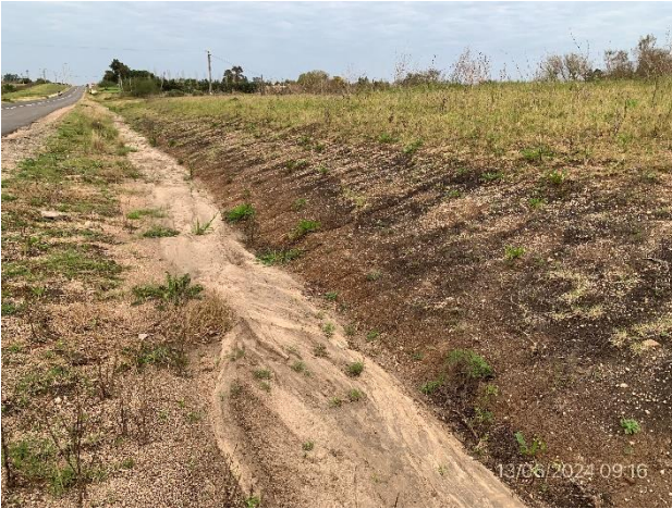
Foto 12.1-7. Contratalud con señales de erosión a causa de falta de tapiz vegetal.
