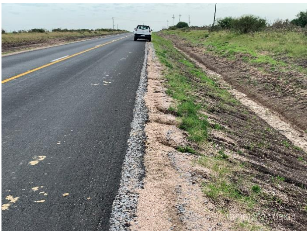
Foto 12.1-5. Calzada de Ruta 63 con sector descalzado, falta de perfilado y compactación. Senda a (+).
