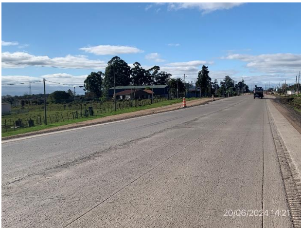
Foto 12.2-3. Sector de Ruta 8 con nueva calzada abierta al tránsito. Whitetopping y banquetas ejecutadas.
