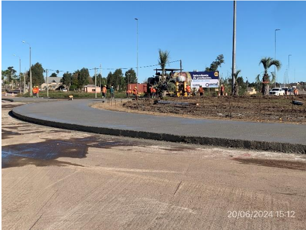
Foto 12.2-7, P02. Fin de tramo, Ruta 8 progresiva 288K000. Empalme con Ruta 17. Rotonda en construcción.
