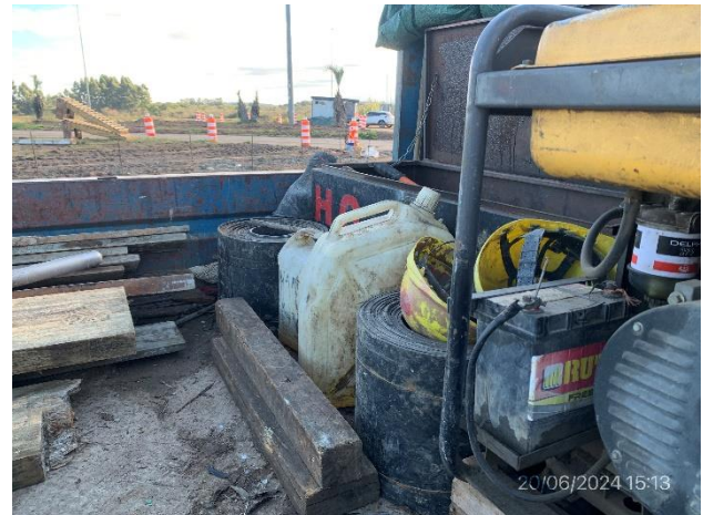
Foto 12.2-10, P02. Camión – taller de apoyo con equipos y lubricantes sin elementos de contención para prevención de derrames.
