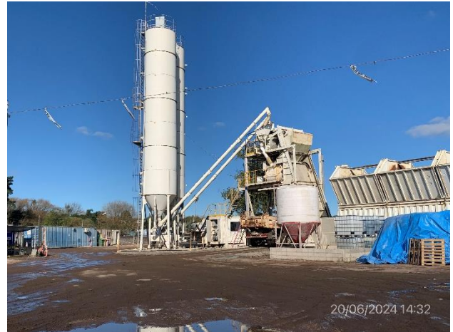
Foto 12.1-2, P03. Planta de hormigón, buenas condiciones de orden en el proceso productivo.
