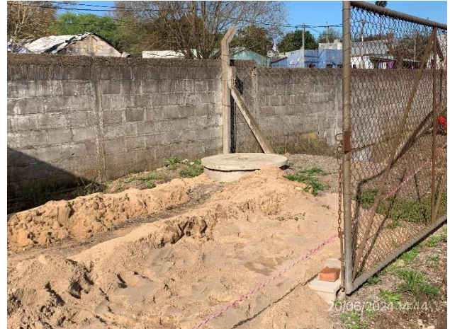
Foto 12.1-8, P03. Depósito impermeable para aguas servidas.
