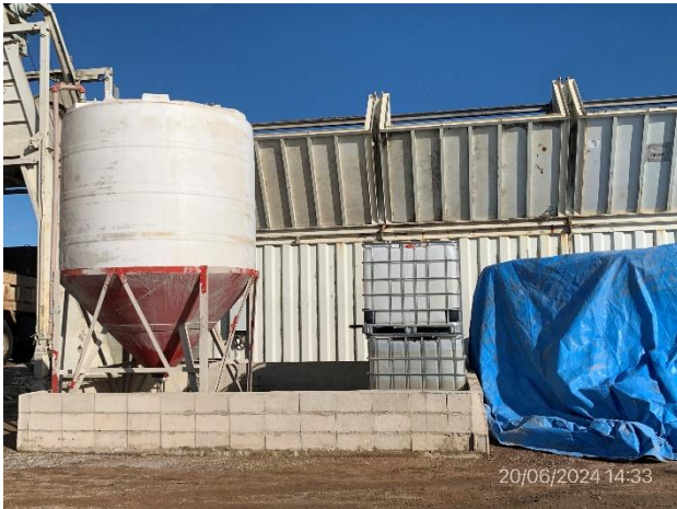
Foto 12.1-3, P03. Depósito de productos químicos en recinto con envallado perimetral.
