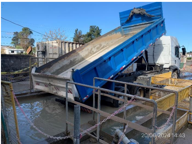
Foto 12.1-5, P03. Pileta de lavado de camiones de hormigón, con circuito cerrado de agua recirculada.
