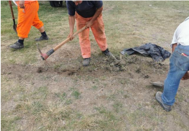
Foto 12.3-1, progresiva 121K700 a (-). La empresa retiró el suelo contaminado con derrame de emulsión asfáltica y le dio disposición final como residuo peligroso.
