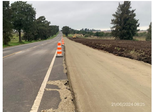
Foto 12.2-8, P06. Frente de obras, ejecución de terceros carriles, Ruta 23, progresiva 139K000 a (-)
