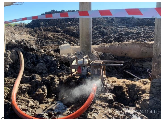
Foto 12.2-6, P01. Motobomba en funcionamiento para depresión de nivel freático, no cuenta con bandejas u otro elemento para contención de eventuales derrames.
