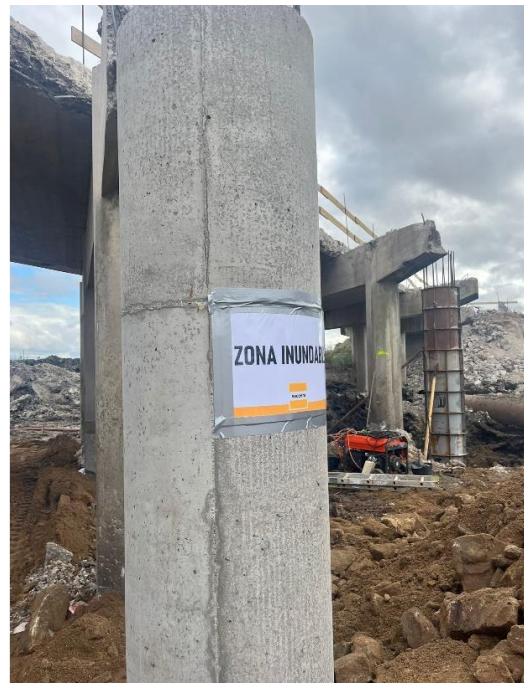
Foto 12.3-4, P01. Puente en obra, se instaló señalización de advertencia de zona inundable.
