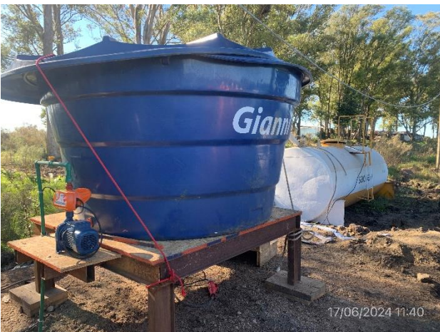
Foto 12.1-5, P02. Obrador, tanque de agua no potable.
