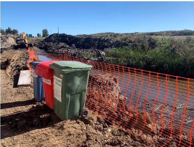
Foto 12.2-9, P01. Infraestructura a pie de obra para gestión de residuos segregados por origen.
