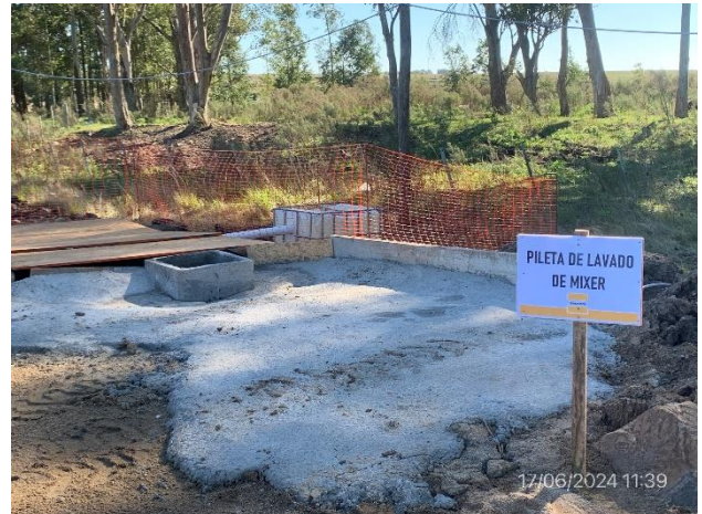
Foto 12.1-4, P02. Obrador, sector de lavado de camiones mixer con interceptores para decantación.
