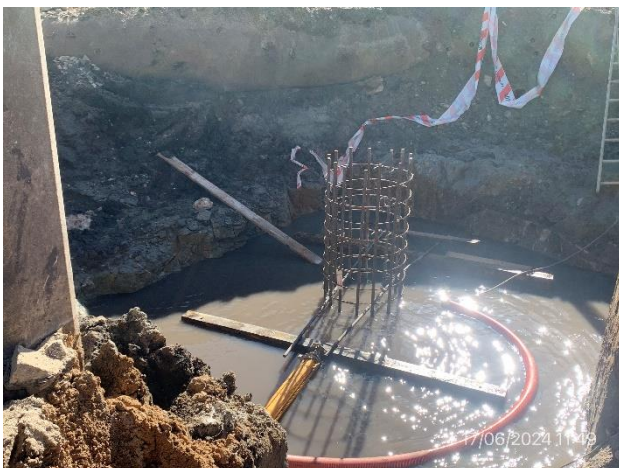
Foto 12.2-5, P01. Cimentación directa en construcción con , depresión del nivel freático por medio de motobomba.
