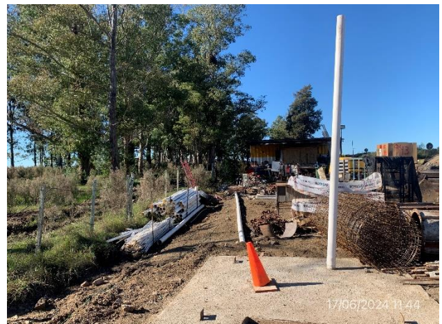
Foto 12.1-6, P02. Obrador, depósito impermeable para aguas servidas. No se indica cota de máxima inundación.
