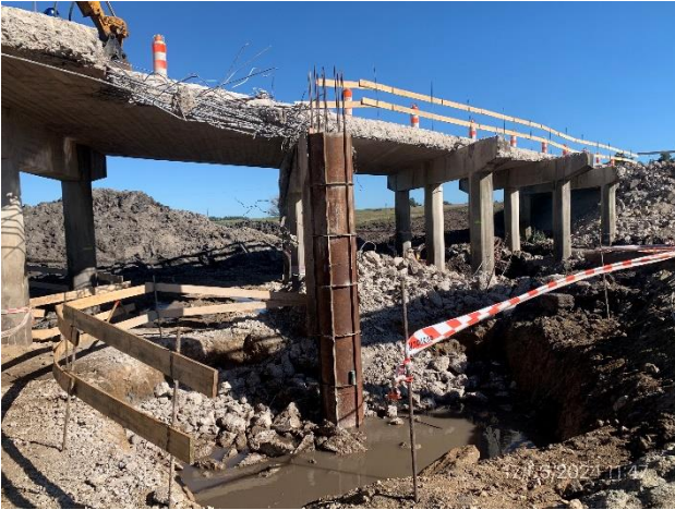
Foto 12.2-7, P01. Encofrados metálicos para nuevos pilares en ejecución. Buenas condiciones de limpieza.
