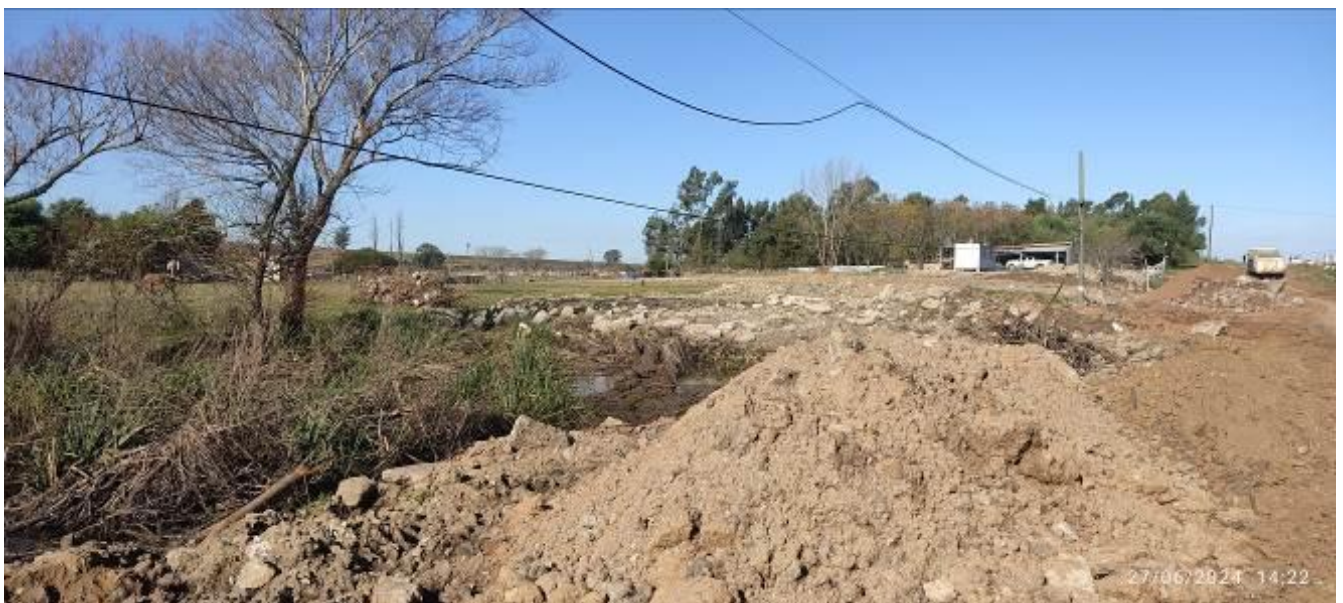
Foto 12.2-1 Excedentes del material en zona inundable.
