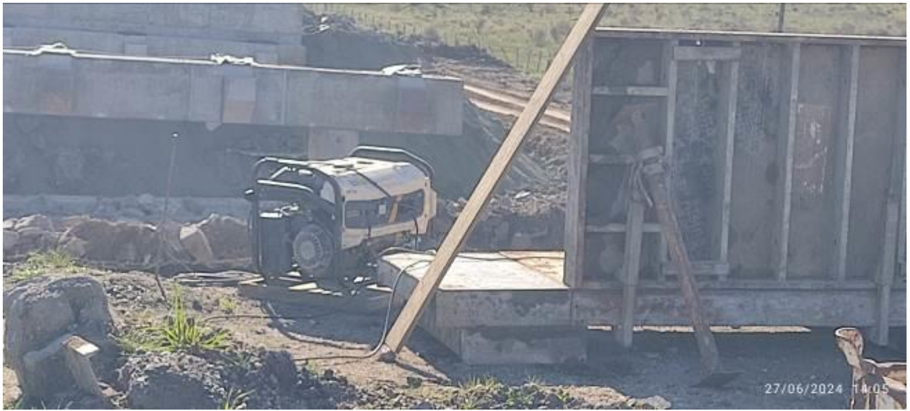
Foto 12.3-1 Dique de contención de generador no estanco.
