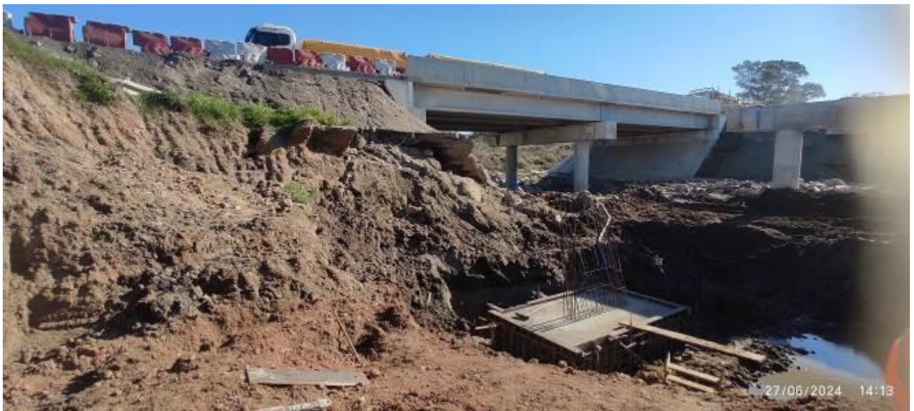
Foto 12.1-1 Excavación con riesgo de derrumbe.
