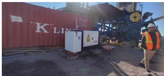
Foto 12.5-1 Generador sin dique de contención.
