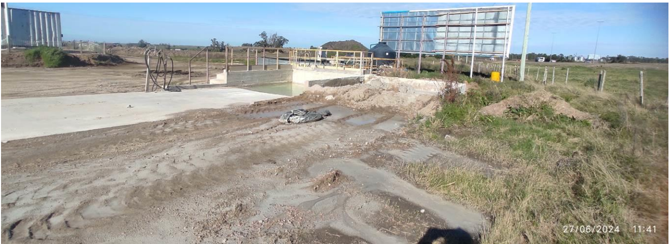
Foto 12.2-1 Derrames en torno a pileta de lavado de hormigón.
