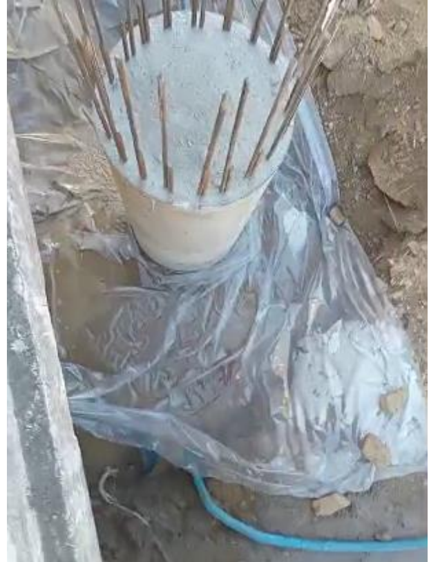
Foto 12.3-2, P01. Pilotaje con tubo Tremie en ejecución. Las aguas mezcladas con lechada de hormigón acumuladas en el punto bajo son bombeadas.
