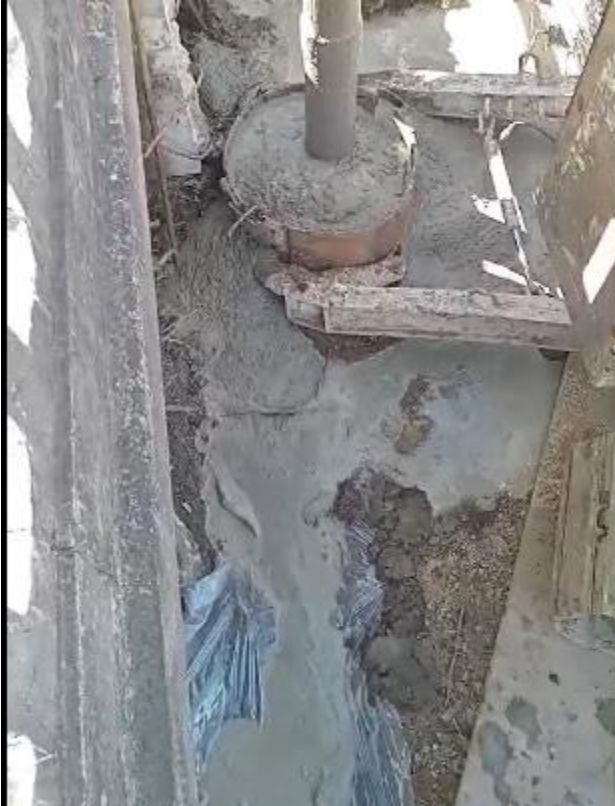
Foto 12.3-1, P01. Pilotaje con tubo Tremie en ejecución. Las aguas mezcladas con lechada de hormigón escurren a un punto bajo sobre una protección de nylon.
