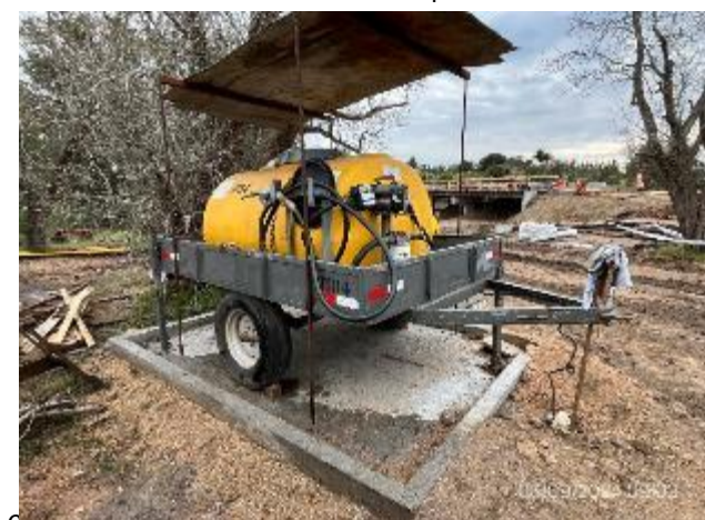
Foto 12.2-12, P02. Campamento provisorio. Recinto envallado para alojar surtidor de combustible.
