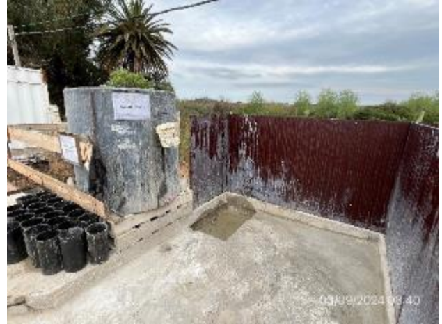
Foto 12.1-12, P01. Pileta de decantación de aguas de lavado de elementos en contacto con hormigón.
