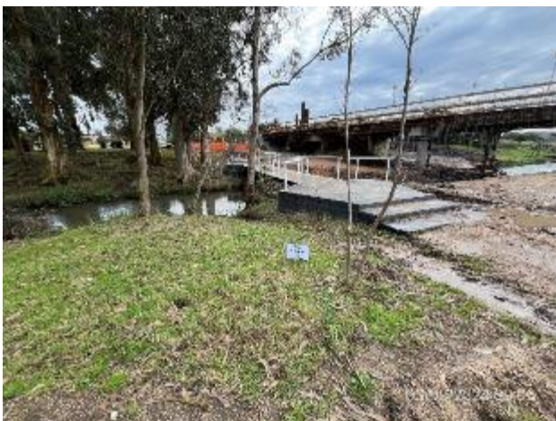
Foto 12.2-5, P02. Cota de máxima inundación correctamente demarcada.
