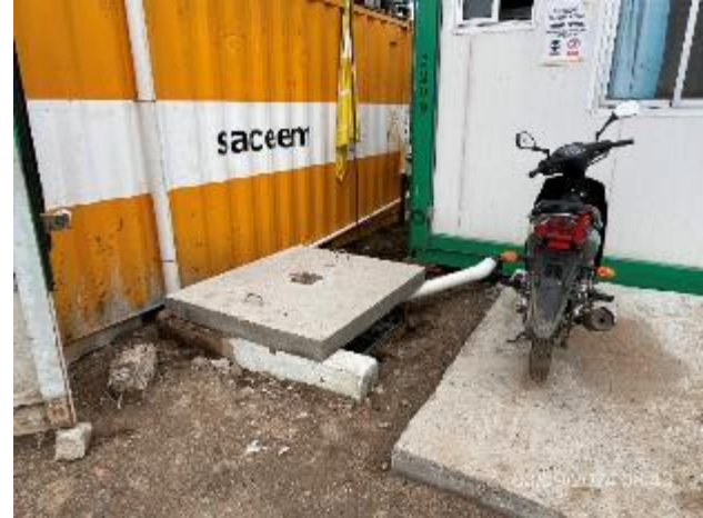
Foto 12.1-18, P01. Depósito impermeable para contención de aguas servidas.
