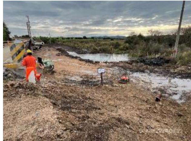
Foto 12.1-6, P01. Demarcación de cota máxima de inundación. Grupo electrógeno sobre bandeja estanca.
