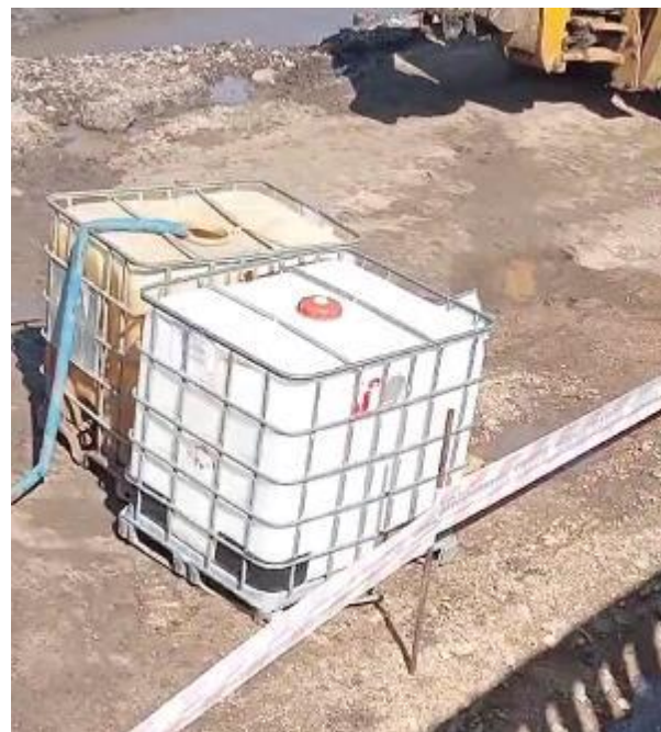
Foto 12.3-4, P01. Aguas mezcladas con lechada de hormigón, a ser tratadas como aguas contaminadas..
