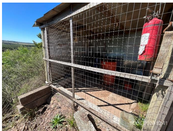
Foto 12.1-24, P04. Zona de acopio de lubricantes de empresas subcontratistas con envallado perimetral impermeable.
