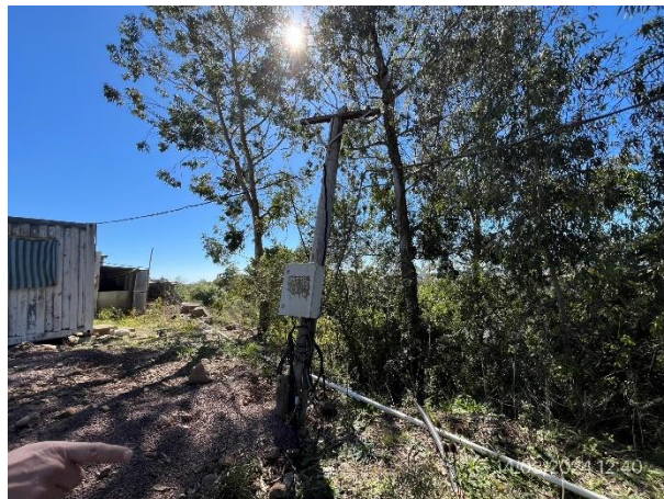
Foto 12.1-20, P04. Se ejecutó tendido eléctrico provisorio por medio de estructura de madera.
