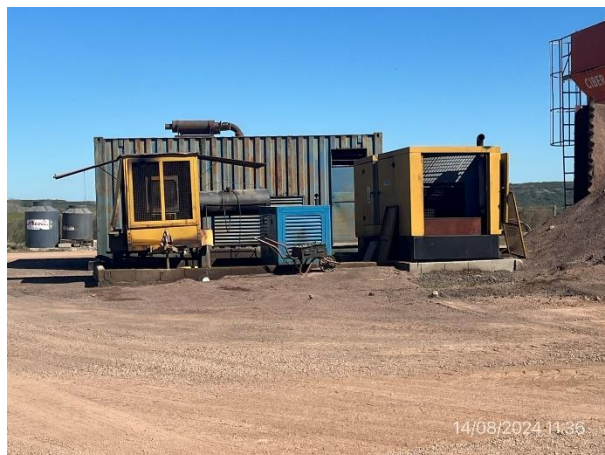
Foto 12.1-8, P03. Obrador, generadores eléctricos dotados de envallados perimetrales.
