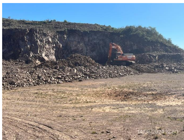
Foto 12.1-12, P04. Frente de explotación, no hay servicios higiénicos.
