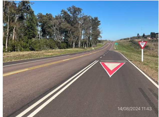
Foto 12.2-2, P05. Tercera vía abierta al tránsito y con señalización horizontal y vertical terminadas.
