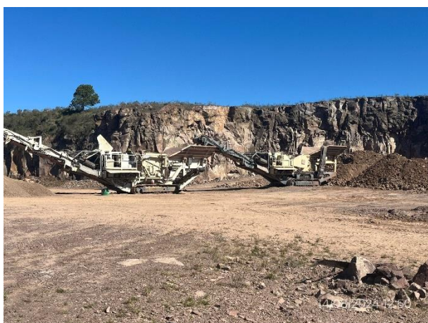
Foto 12.1-11, P04. Obrador secundario, cantera de basalto y planta de trituración. Padrón 12240, 2ª SC de Tacuarembó, Ruta 5 progresiva 368K500 a (-).
