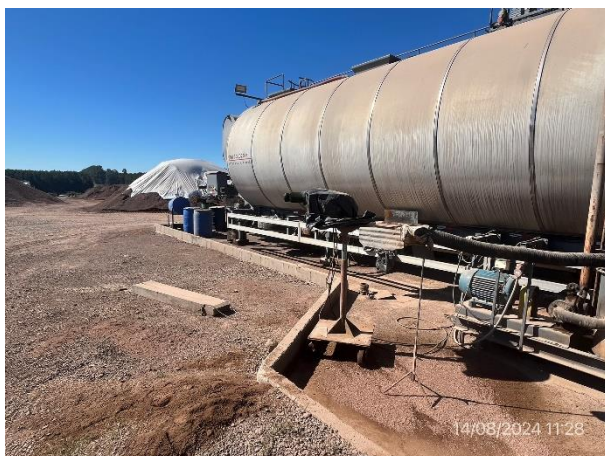
Foto 12.1-4, P03. Planta asfáltica, cisterna de emulsión con envellado perimetral impermeable.
