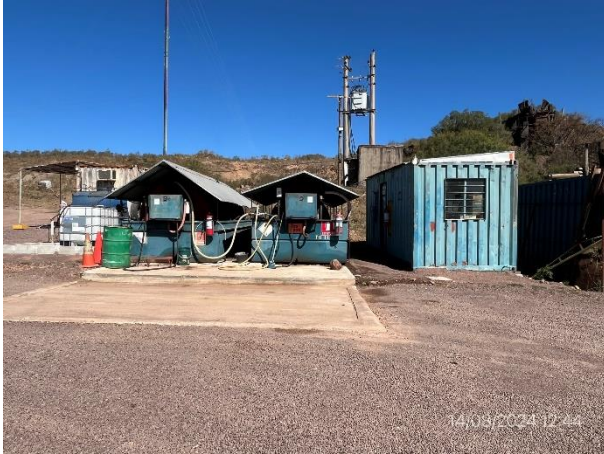
Foto 12.1-13, P04. Tanques de combustible envallados y techados.
