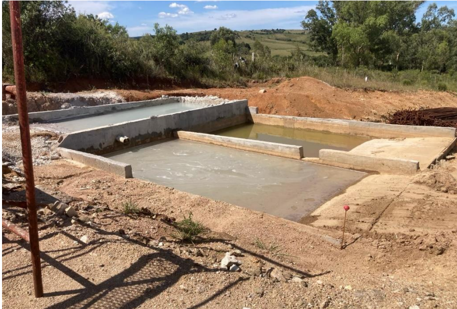
Ilustración 3: Piletas de lavado de mixers.
