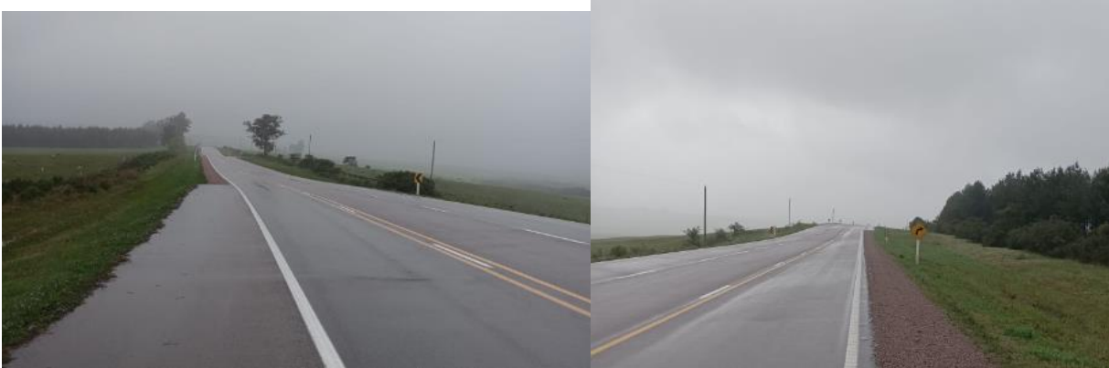
Estado de faja y pavimento
