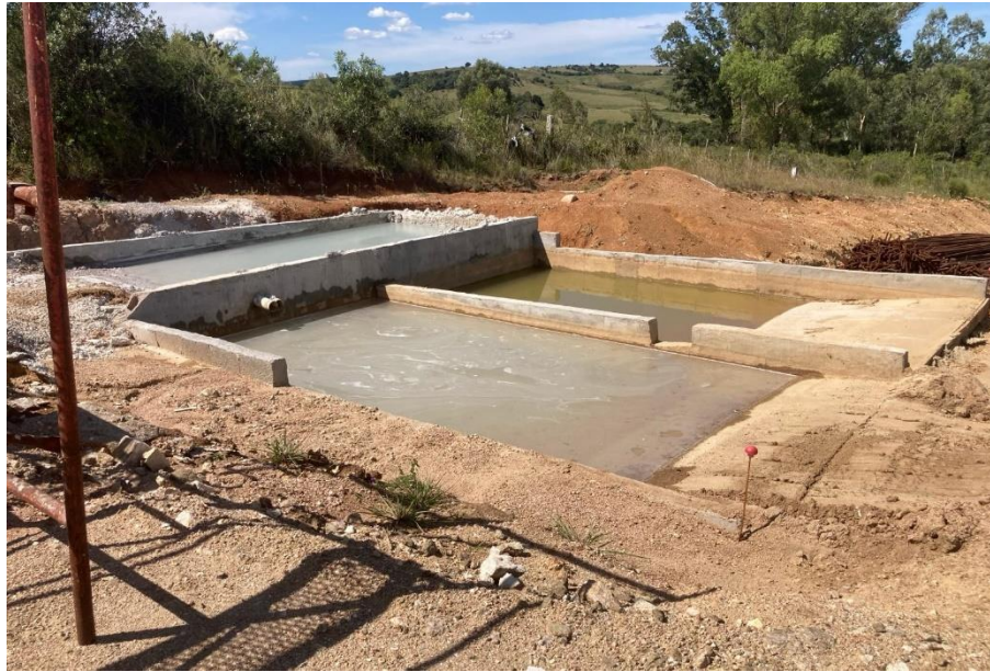
Ilustración 3: Piletas de lavado de mixers.
