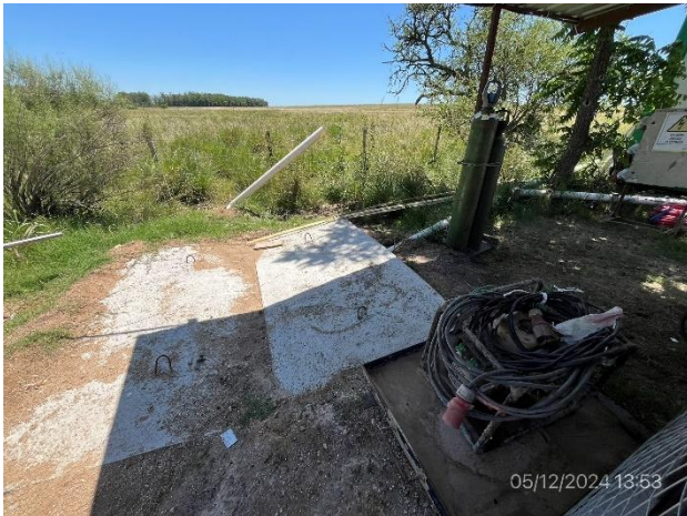
Foto 12.3-9, P03. Depósito impermeable para contención de aguas servidas.
