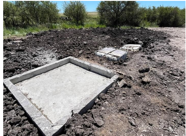
Foto 12.3-10, P03. Pileta de lavado de camiones mixer, de construcción reciente.
