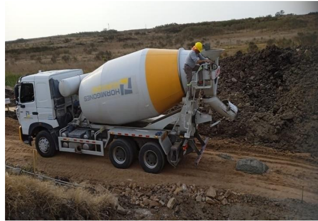
Foto 12.4-2. Proveedor Hormigones Durazno descartando hormigón fresco sobre suelo desnudo, fuera del sector previsto. Fotografía remitida por DNV – MTOP durante la Auditoría Ambiental.
