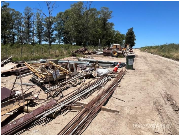
Foto 12.1-9, P01. Obrador, acopio de materiales pendientes de ser removidos.
