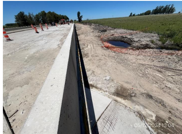
Foto 12.1-4, P01. La ataguía granular no se remueve y queda al servicio de la obra vial de los accesos al puente.
