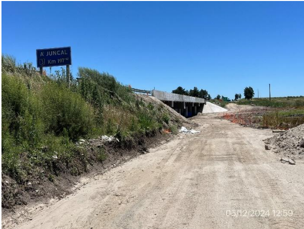
Foto 12.1-1, P01. Nuevo Puente en obra sobre A° Juncal y obrador de SACEEM. Ruta 3 progresiva 197K620
