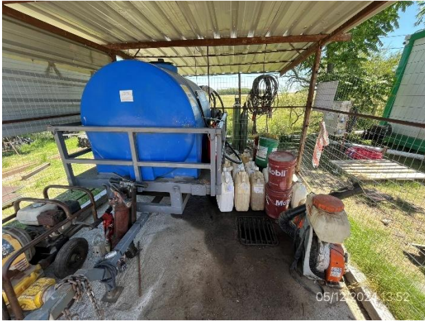
Foto 12.3-7, P03. Recinto cerrado y envallado con pavimento impermeable para alojar tarrinas con combustible y productos químicos.
