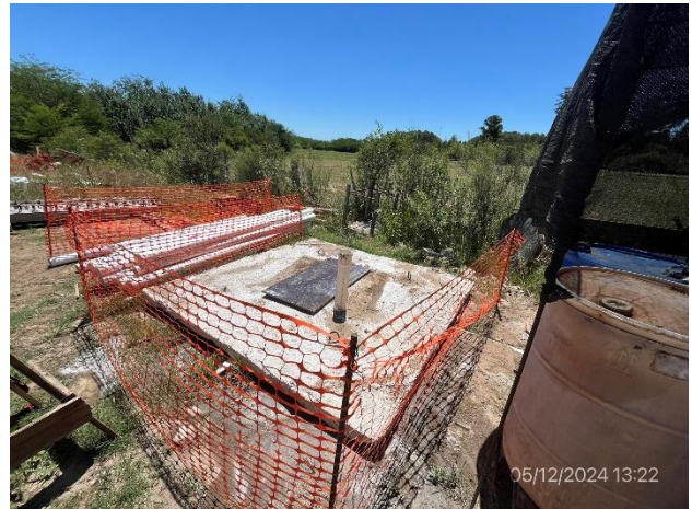
Foto 12.2-10, P02. Depósito impermeable para contención de aguas servidas.
