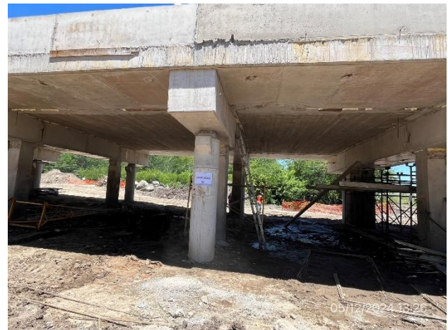
Foto 12.2-4, P02. Cota de máxima inundación correctamente demarcada.
