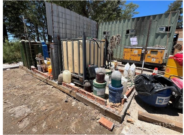
Foto 12.1-8, P01. Obrador, el recinto envallado fue desmantelado pero permanecen tarrinas y bidones de lubricantes y productos químicos.
