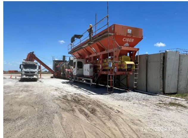
Foto 12.1-13, P03. Planta asfáltica, buenas condiciones de orden y limpieza, no hay derrames a la vista.
