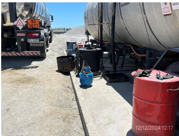
Foto 12.1-14, P03. Planta asfáltica, envallados correctos para la contención de eventuales derrames.
