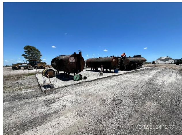
Foto 12.1-15, P03. Planta asfáltica, parque de cisternas de emulsión correctamente envallado.
