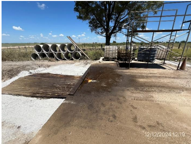
Foto 12.2-7, P03. Obrador, lavadero de camiones con pendientes adecuadas hacia trampa de grasas y aceites.
