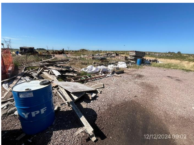
Foto 12.1-5, P05. Obrador Gofinal SA, zona desordenada con residuos dispersos y derrames oleosos.
