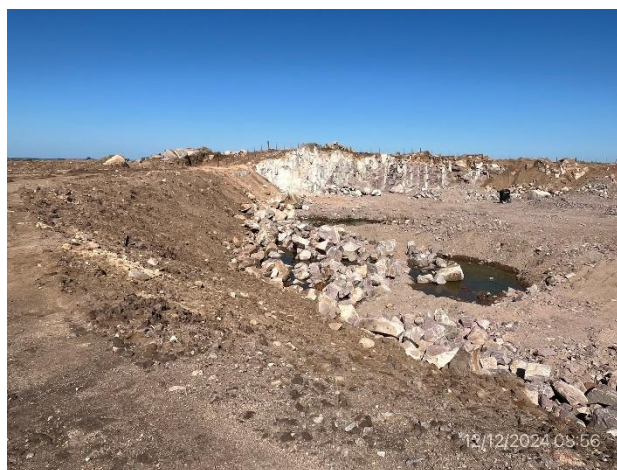
Foto 12.1-4, P05. Cantera, frente de ataque. Taludes suavizados, queda remanente de piedra volada
