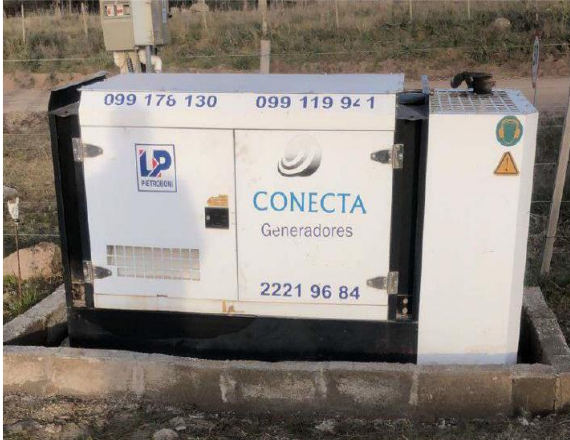
Foto 12.3-1, P05. Para cada generador se construyeron envallados de contención de hormigón.
