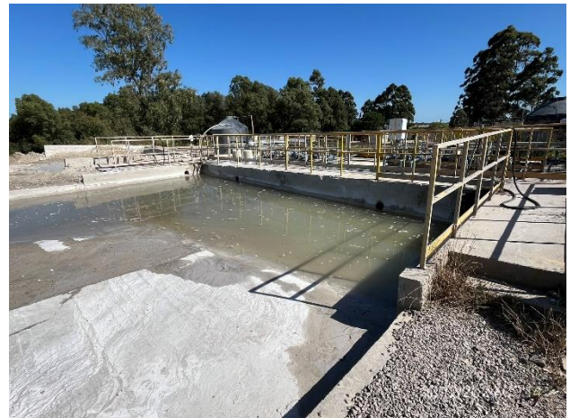
Foto 12.2-4, P03. Pileta de lavado de camiones mixer con sistema cerrado de recirculación de aguas de lavado.
