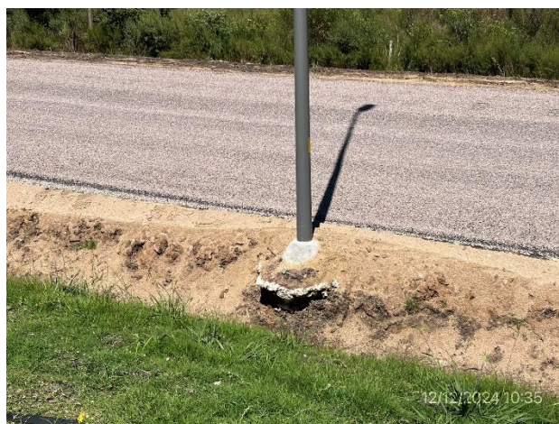
Foto 12.1-12, Ruta 5. Columna de iluminación con cimentación afectada por escorrentía pluvial
