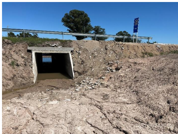
Foto 12.1-8, P11. Ruta 5 progresiva 81K900, Pasaganado con talud erosionado en acceso, sendas a (+) y a (-).
