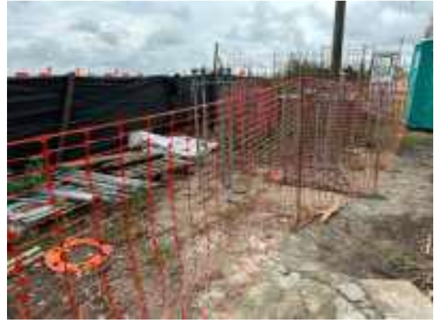
Foto 12.5-2, P03. Se retiraron y fueron a disposición final los residuos previamente dispersos.
