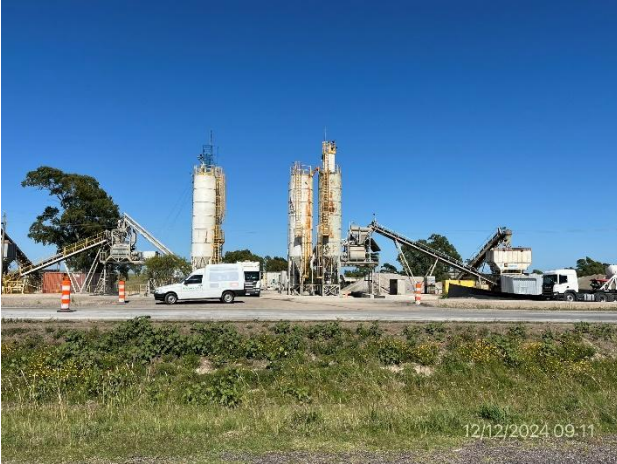
Foto 12.2-1, P03. Obrador central del Consorcio y planta de hormigón n°1. Ruta 5 progresiva 88K600 a (-).
