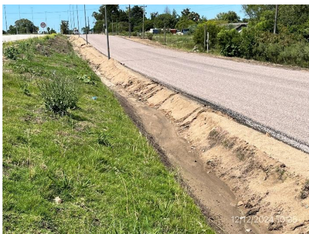
Foto 12.1-11, Ruta 5, calle secundaria de Ruta 5, cuneta erosionada por escorrentía pluvial
