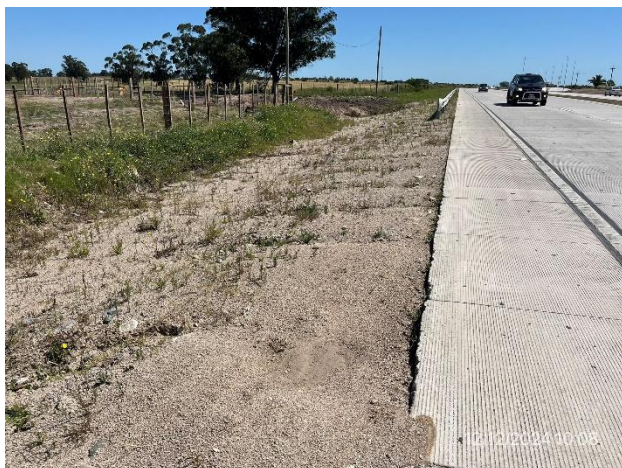
Foto 12.1-7, Ruta 5, talud senda a (-) erosionado por escorrentía pluvial.
