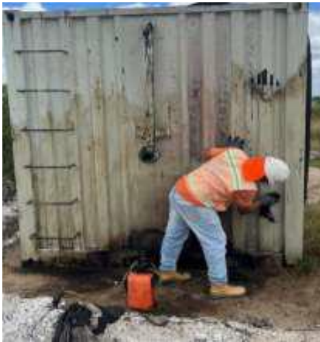
Foto 12.5-3, P06. Se removió el suelo contaminado con derrames oleosos del depósito de emulsión.
