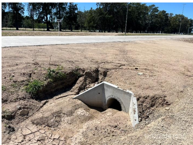
Foto 12.1-9. Ruta 5, alcantarilla longitudinal. Cabezal con zona de recubrimiento erosionada por escorrentía pluvial.
