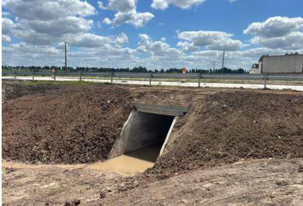
Foto 12.5-7, P11. Paso de ganado terminado y habilitado. Ruta 5 progresiva 81K900. Se recompusieron los taludes para favorecer el drenaje.
