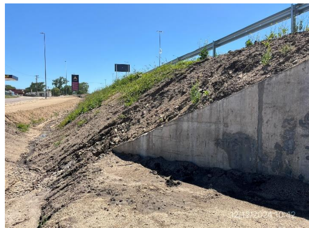
Foto 12.1-6, P08. Cabezales de paso peatonal con taludes erosionados.
