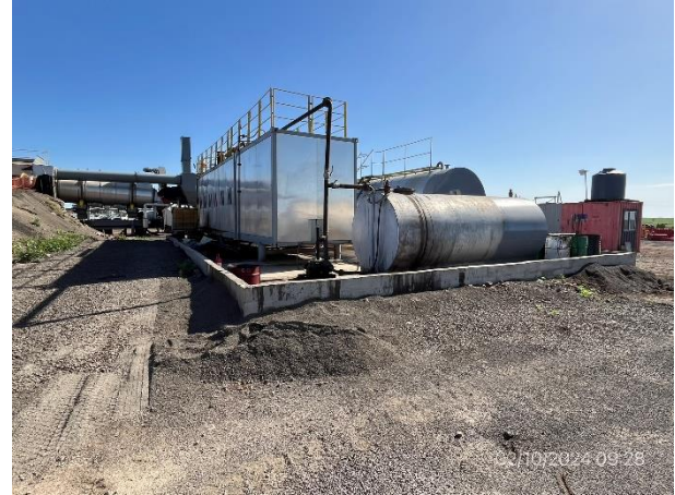
Foto 12.2-8, P03. Planta asfáltica con envallado perimetral impermeable correcto.
