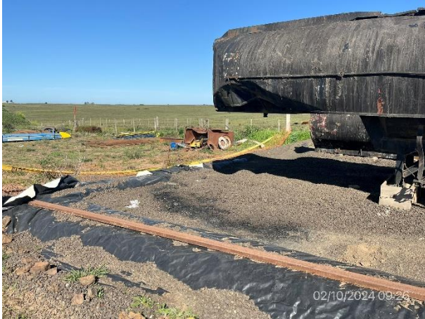
Foto 12.2-7, P03. Explanada envallada de estacionamiento de cisternas de emulsión asfáltica. Hay derrames oleosos sin disponer.
