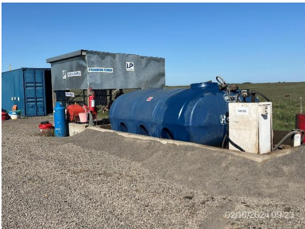
Foto 12.2-3, P03. Tanque de combustible con envallado perimetral impermeable. Zona libre de derrames.
