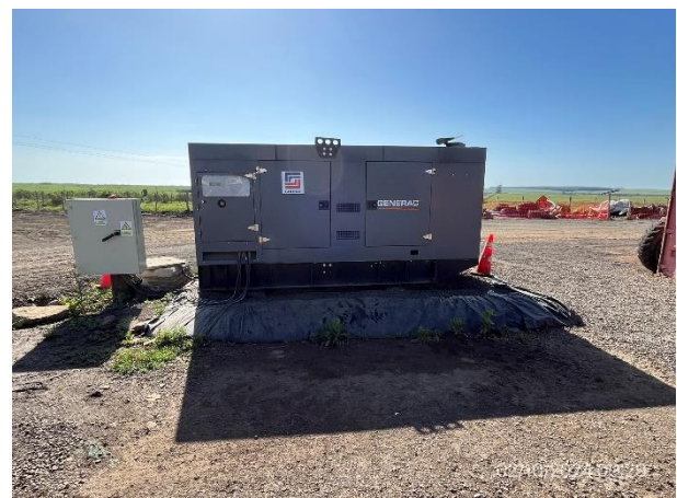
Foto 12.2-6, P03. Generador eléctrico con envallado impermeable
