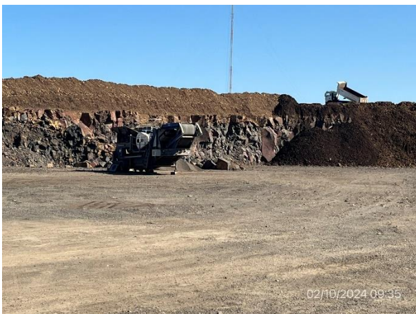
Foto 12.2-11, P03. Cantera de piedra, sin actividad. Explanada libre de derrames, se desmantelaron los servicios accesorios.
