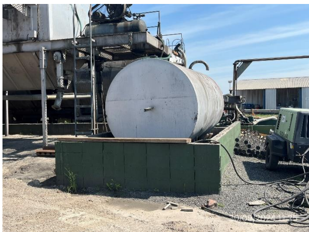
Foto 12.1-11, P05. Planta asfáltica, tanque de fuel – oil correctamente envallado.
