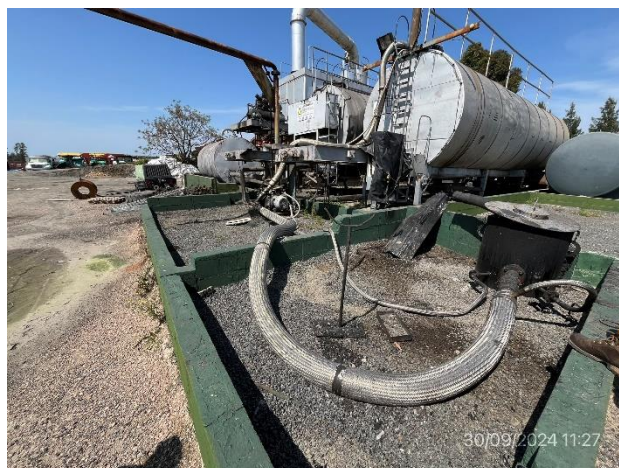
Foto 12.1-12, P05. Planta asfáltica, capacidad de envallado perimetral reducida por desnivel en altura.
