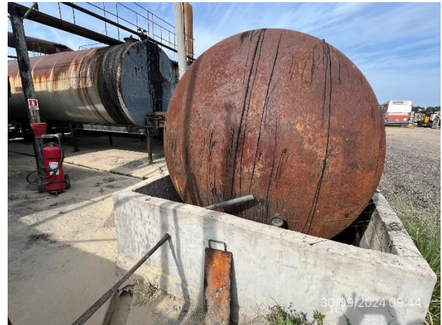
Foto 12.3-4, P06. Planta asfáltica, tanque de combustible en envellado impermeable.
