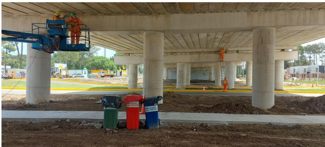
Foto 12.4-3, P01. Se instaló estación para acopio temporal de residuos segregados por corriente de generación.
