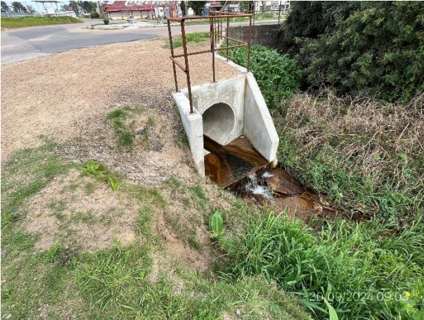
Foto 12.2-11, P01. Cabezal de red de tuberías drenantes senda a (+), talud erosionado por falta de tapiz vegetal.
