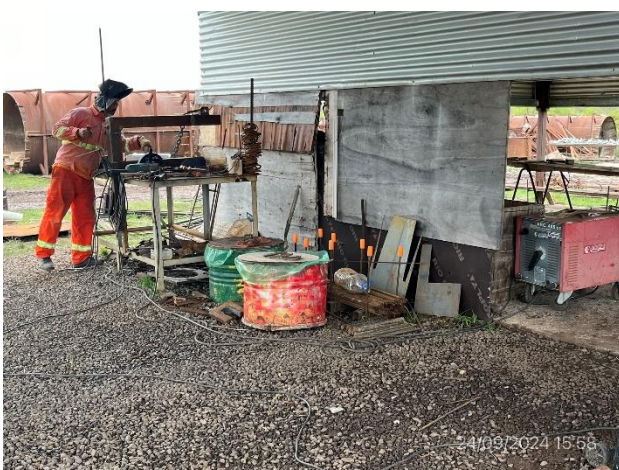
Foto 12.1-9, P04. Obrador. Sector de taller de confección de armaduras en buenas condiciones de orden y limpieza.
