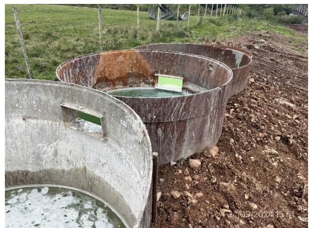
Foto 12.1-8, P04. Obrador, planta de sedimentación de aguas provenientes del lavado de herramientas en contacto con hormigón.
