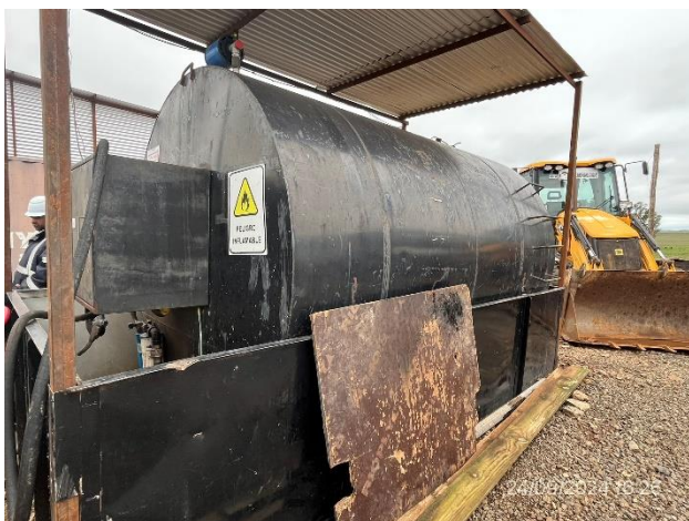
Foto 12.2-5, P03. Depósito y surtidor de combustible en local techado y envaseado.
