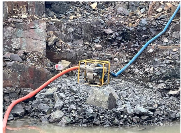
Foto 12.2-10, P03. Cantera, se realiza bombeo de pluviales por medio de motobomba sin bandeja de contención.
