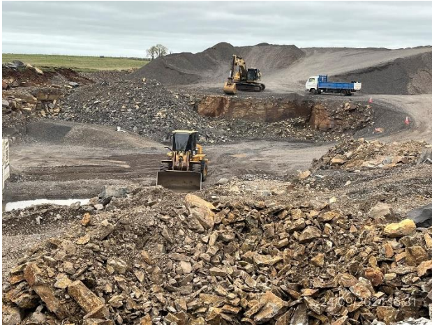
Foto 12.2-7, P03. Cantera y tren de trituración. Frente de explotación. No hay baños químicos próximos a la zona de trabajo.
