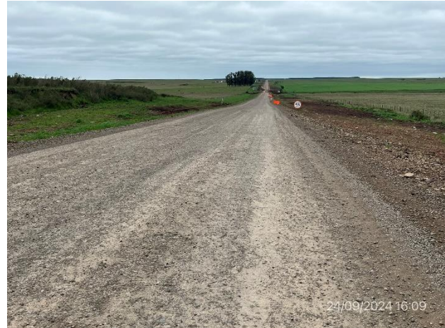
Foto 12.3-2. Tramo de Ruta 20 con obras de ensanche de plataforma y bacheo de carpeta existente terminadas
