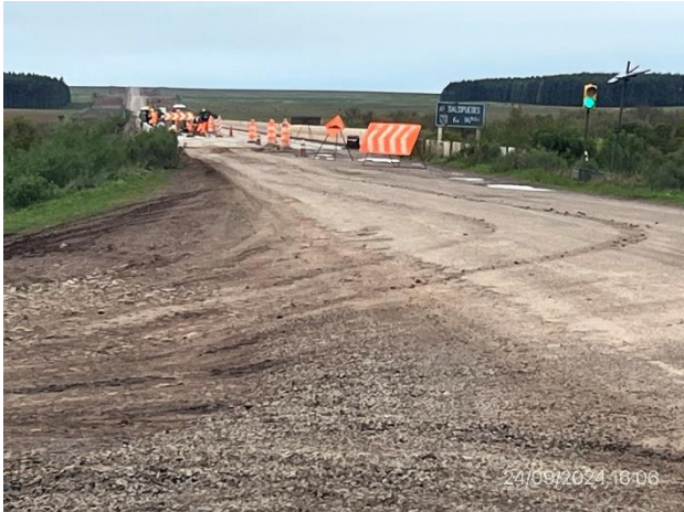
Foto 12.3-1, P02. Fin de tramo, Ruta 20 progresiva 147K200. Acceso Oeste a puente sobre A° Salsipuedes.
