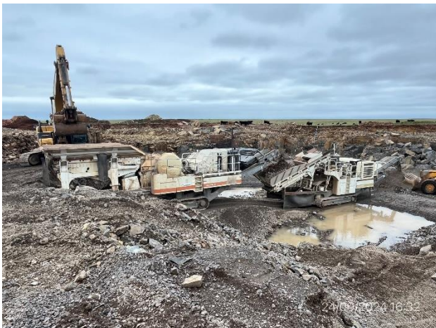
Foto 12.2-9, P03. Tren de trituración. No está la infraestructura prevista en el PGA para el acopio temporal de residuos segregados por origen.
