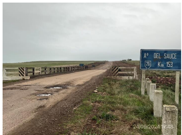
Foto 12.2-12, P03. Puente con obra aún sin iniciar sobre A° Sauce. Ruta 20 progresiva 152K980.
