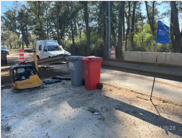
Foto 12.2-3, P01. Estación para acopio temporal de residuos a nivel de tablero superior.
