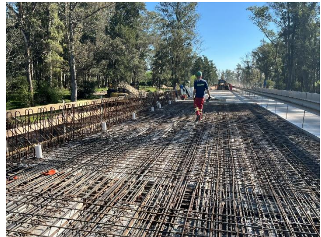
Foto 12.2-2, P01. Armaduras de tablero superior en proceso de colocación previo al llenado.
