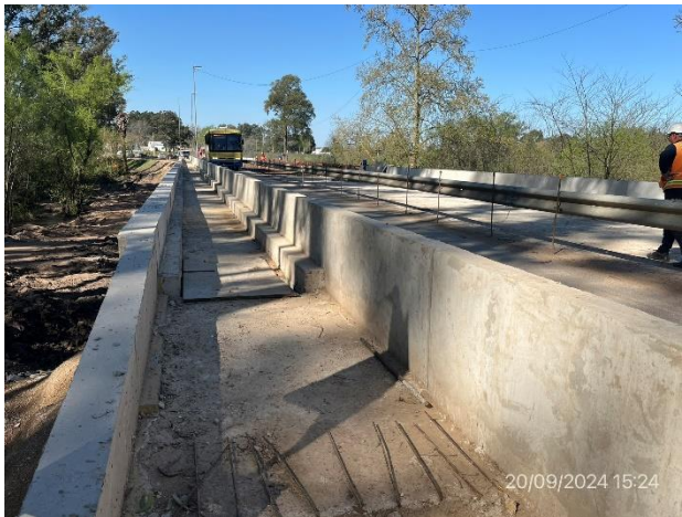
Foto 12.2-1, P01. Puente principal sobre Arroyo Canelón Chico en obra. Ruta 11 progresiva 99K750.
