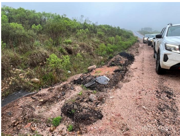
Foto 12.1-5, P07. Ruta 7 progresiva 290K500 a (+), ROCs de mezcla asfáltica dispersos.
