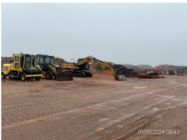
Foto 12.2-5, P03. Obrador y Planta Asfáltica, Padrón rural N° 8942 de la 8ª S.C. de Treinta y Tres.
