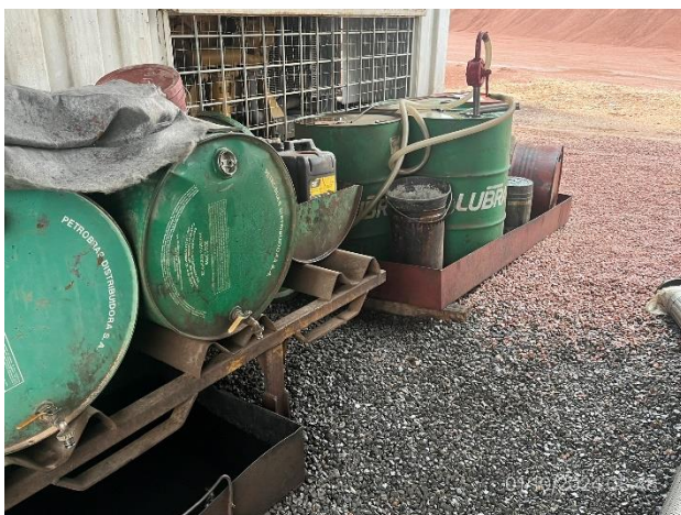
Foto 12.2-17, P03. Generador eléctrico, tarrinas de lubricantes bajo techo y sobre bandejas.
