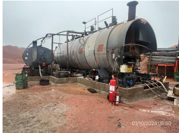
Foto 12.2-14, P03. Planta asfáltica, el envallado perimetral no contiene el 110% de un posible eventual derrame.
