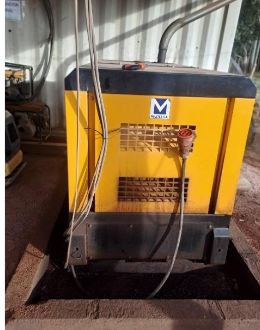
Foto 12.3-2, P03. Se retiró el cable conector de dentro de la bandeja y se colocó un gancho que evitará que se repita la situación.
