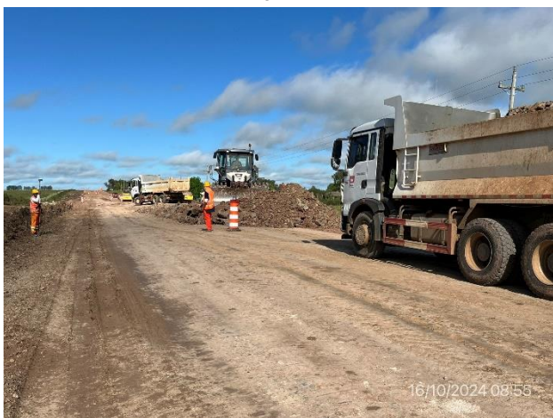
Foto 12.2-9, P04. Frente de obras, Ruta 6 progresiva 312K100. Tareas de recargo granular en ejecución
