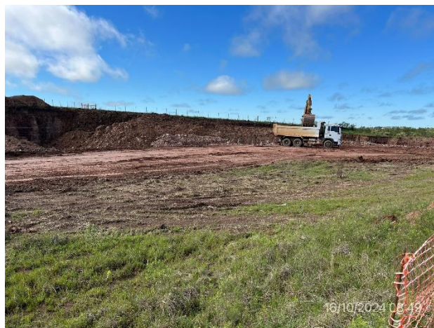
Foto 12.2-8, P05. Extracción de materiales de faja pública con destino a subrasante de ensanche de trazado.
