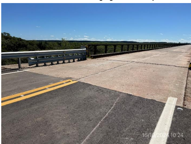
Foto 12.2-11, P01. Inicio de tramo. Acceso Sur a Puente 329K sobre el Río Negro, paraje "Paso de las Piedras". Ruta 6 progresiva 320K000.
