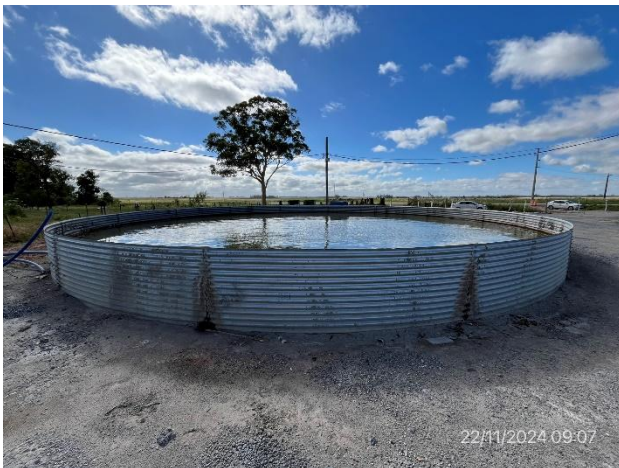
Foto 12.1-7, P03. Tanque australiano para recirculación de agua no potable.
