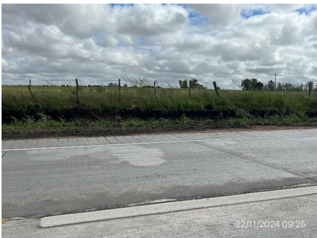
Foto 12.2-5, Ruta 25, tramo de faja pública angosto, no permite realizar cunetas con pendientes adecuadas. El talud vertical queda expuesto a posibles erosiones.
