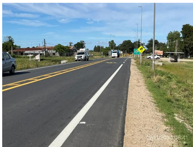
Foto 12.2-2, Ruta 45. Obras de reacondicionamiento terminadas y abiertas al tránsito, con obras señalización e iluminación ejecutadas.
