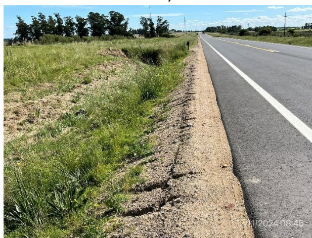
Foto 12.2-4. Ruta 45, faja pública en erosionada por escurrimiento pluvial y falta de tapiz vegetal.
