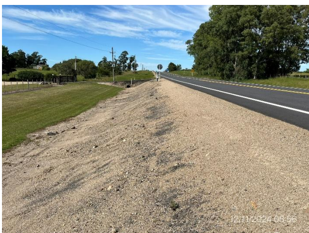
Foto 12.2-5. Ruta 45, faja pública con ausencia de tapiz vegetal, favorece la ocurrencia de eventuales procesos de erosión por escurrimiento pluvial.
