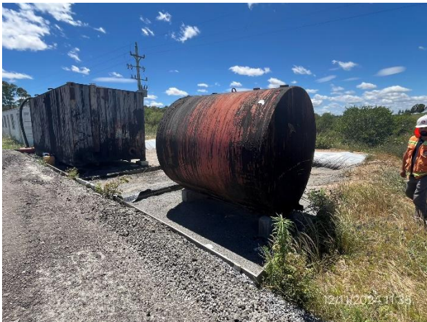
Foto 12.1-11, P03. Planta asfáltica, tanque de emulsión en recinto envallado y con pavimento impermeable.
