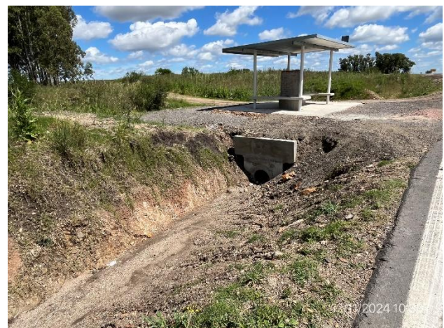
Foto 12.2-8, P07. Dársena de buses y alcantarilla longitudinal. Talud y contratalud con perfilado inadecuado y señales de erosión por escorrenría pluvial.
