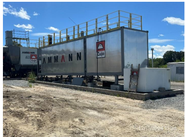
Foto 12.1-10, P03. Planta asfáltica, envallados adecuados para contención de derrames y buenas condiciones de orden y limpieza.
