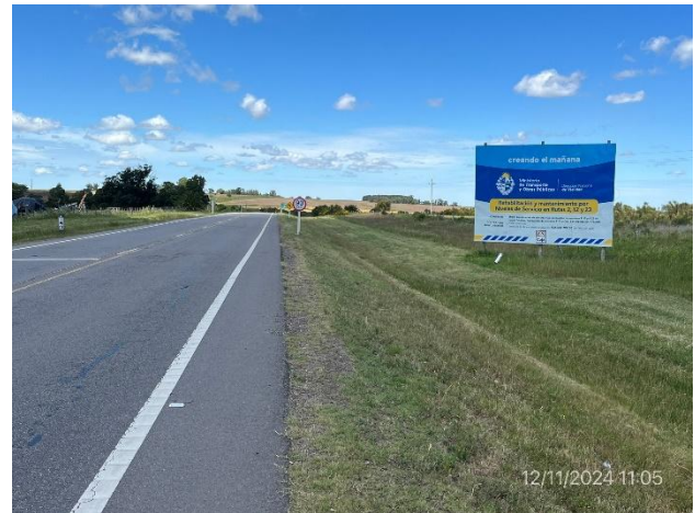
Foto 12.2-10, P02. Fin de obras en Ruta 23, progresiva 152K200, Acceso Este a Ismael Cortinas.
