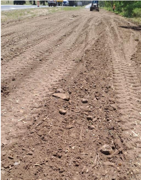
Foto 12.3-1, P06. Ruta 23 progresiva 126K600 senda a (-). Se reconfirmaron las pendientes de la zona.
