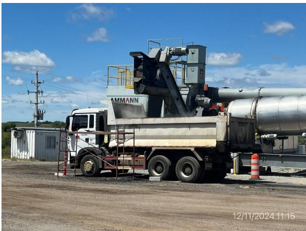
Foto 12.1-9, P03. Planta asfáltica, proceso de carga de mezcla a transporte en camión.
