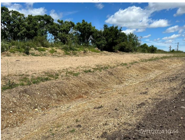
Foto 12.2-7. Sector de faja pública de Ruta 23, con evidencia de erosiones por escurrimiento pluvial.
