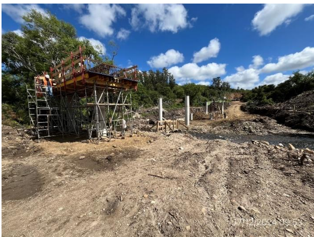
Foto 12.3-5, P06. Falta replicar al pie del frente de trabajo la infraestructura para el acopio temporal de residuos segregados por corriente de generación.
