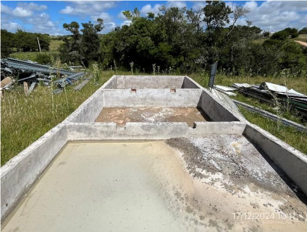
Foto 12.1-7, P03. Obrador, pileta de decantación de aguas de lavado de camiones mixer. Buenas condiciones de limpieza.
