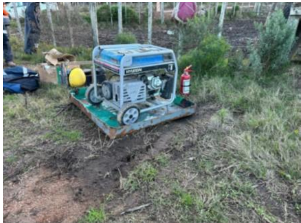
Foto 12.4-3, P07. Se instaló bandeja bajo generador eléctrico
