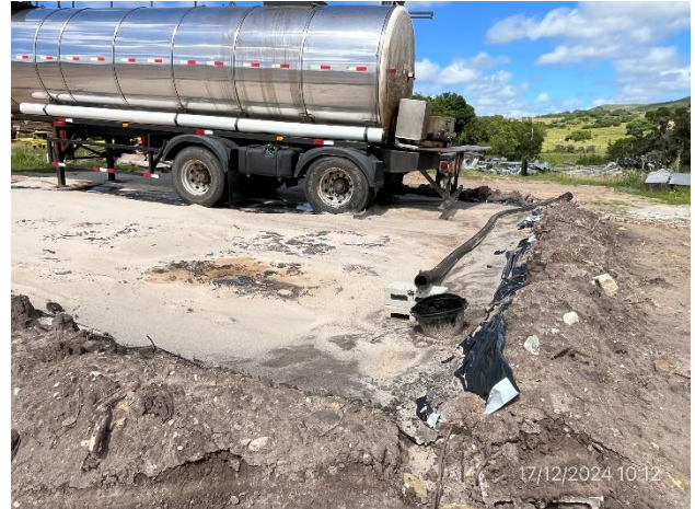
Foto 12.1-8, P03. Obrador, la cisterna de emulsión asfáltica tiene envallado impermeable perforado en el punto bajo.
