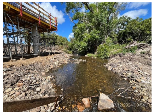
Foto 12.3-6, P06. No está demarcada la cota de máxima inundación.
