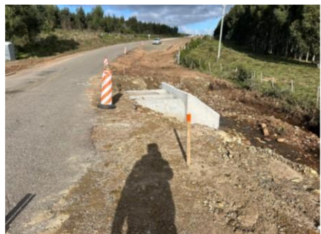
Foto 12.4-6, Ruta 12 progresiva 360K300. Alcantarilla Z, se demarcó la cota de máxima inundación
