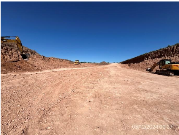
Foto 12.2-3, P04. No están los servicios de bienestar para los operarios. Tampoco hay infraestructura para gestión de contingencias ambientales y acopio temporal de residuos.
