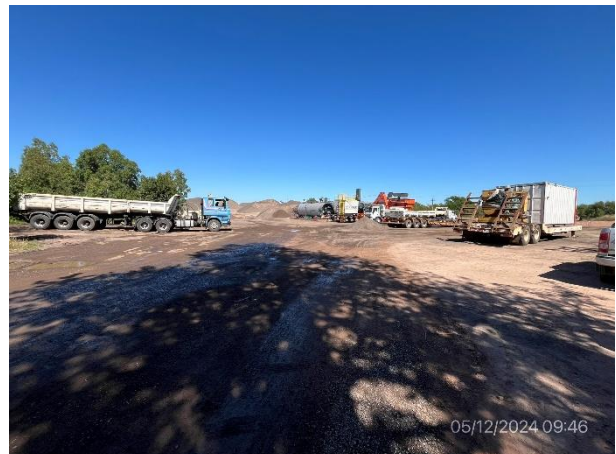
Foto 12.2-4, P03. Obrador y planta asfáltica. Ruta 90 progresiva 31K200 a (-). Padrón N° 1089, 2ª SC de Paysandú.
