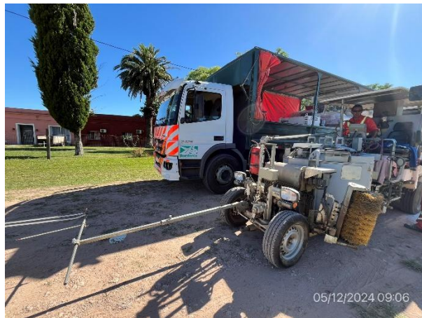
Foto 12.1-8, P06. Trabajos de Bordonix, ejecutados de forma acorde a PGA de la obra.
