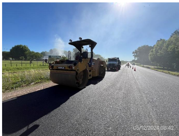
Foto 12.1-2. P07, Ruta 90 progresiva 6K800 a (-). Frente de obras, tendido de mezcla asfáltica
