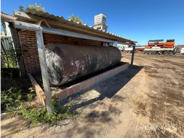
Foto 12.2-13, P03. Obrador, cisterna de combustible en recinto envallado pero de capacidad insuficiente.
