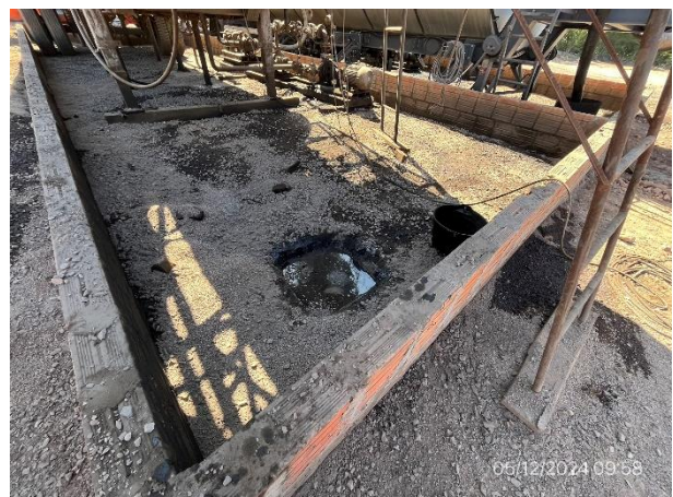
Foto 12.2-6, P03. Planta asfáltica, derrame de emulsión pendiente de remoción y disposición como residuo.
