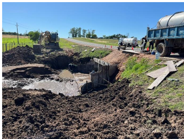
Foto 12.1-6, P08. No se dispone de la infraestructura para el acopio temporal de residuos segregados por origen y la resolución de contingencias ambientales.
