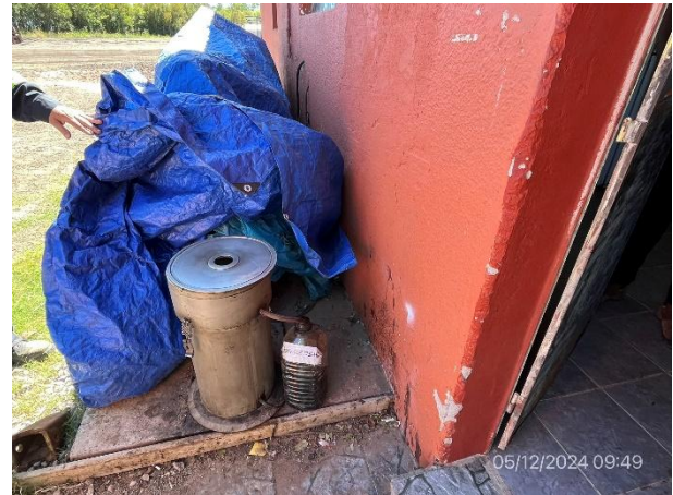
Foto 12.2-10, P03. Laboratorio de asfaltos, el percloroetileno no está alojado en recinto adecuado para contención de eventuales derrames.
