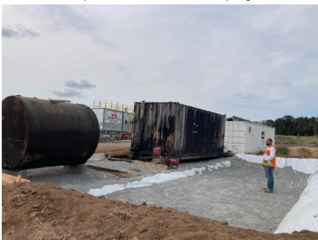
Foto 12.3-3, P03. La empresa ejecutó una nueva explanada envallada impermeable para el depósito de emulsiones asfálticas.
