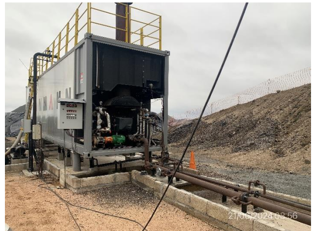
Foto 12.1-8, P03. Planta asfáltica, envallados adecuados para contención de derrames y buenas condiciones de orden y limpieza
