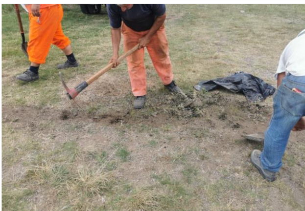
Foto 12.3-1, progresiva 121K700 a (-). La empresa retiró el suelo contaminado con derrame de emulsión asfáltica y le dio disposición final como residuo peligroso.
