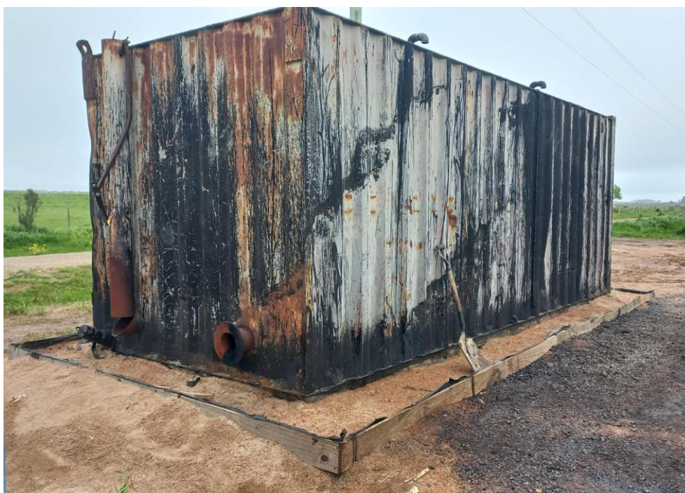
Imagen N°4 y 5: Bandeja de contención de tanques de Emulsión asfáltica R65.
