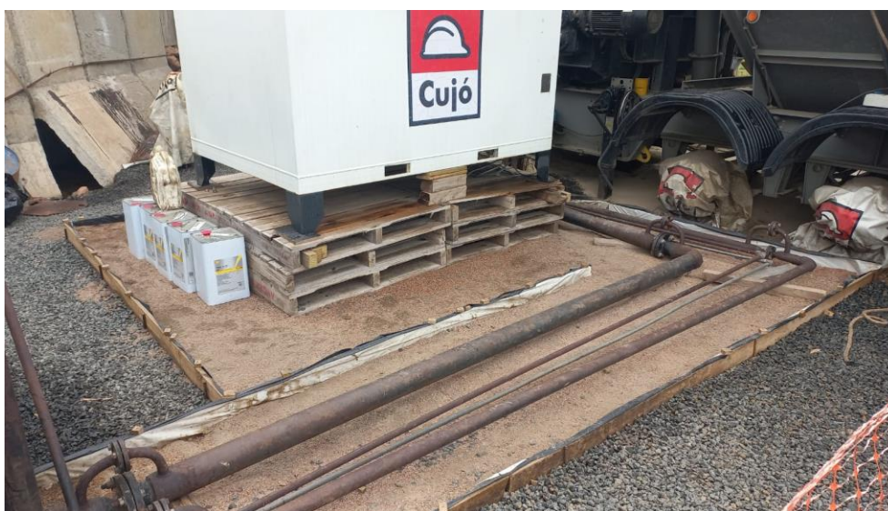
Imagen N° 6 y 7: Bandeja de contención de Planta asfáltica.
