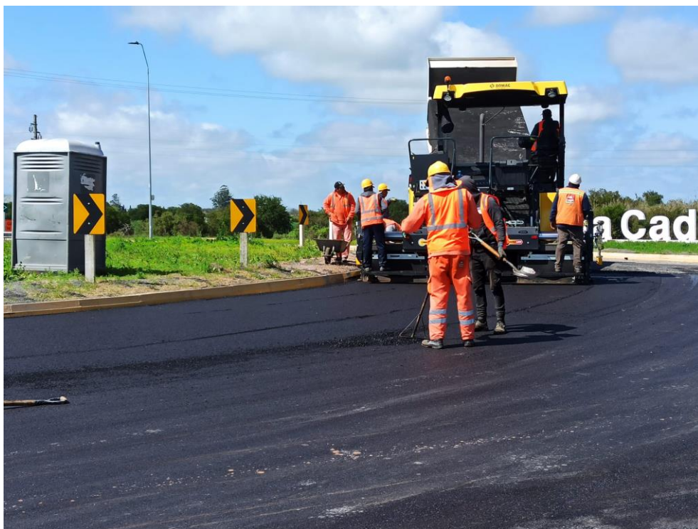
Imagen N° 12: Carpeta asfáltica en la rotonda en ruta N° 81 y 64, en Paso de la Cadena.
