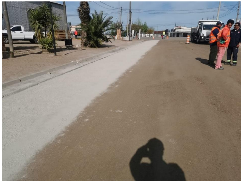
Imagen N°5 y 6: Reciclado con cemento de la base en planta urbana Ismael Cortinas.
