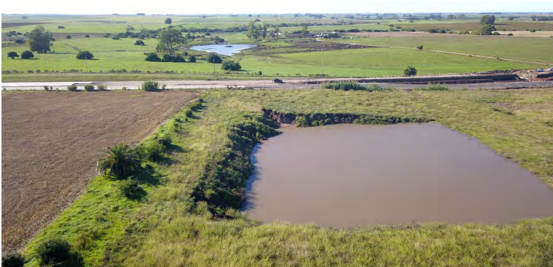
Foto 3. Taludes con corrección de pendiente. Se distinguen algunos surcos de erosión sin riesgo de aterramiento al curso superficial.
