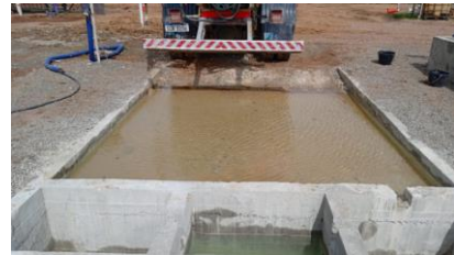
Pileta lavado de mixer
