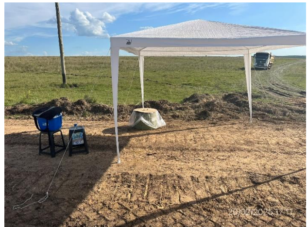
Foto 12.2-10, P05. Frente de obras, la infraestructura para acopio temporal de residuos y atención de contingencias está incompleta.
