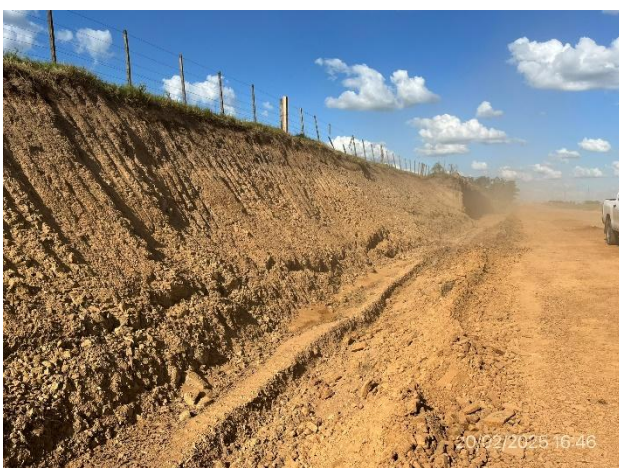
Foto 12.2-5, P07. Con la obra inconclusa, existe gran diferencia de nivel con el terreno lindero y el alambrado está inestable
