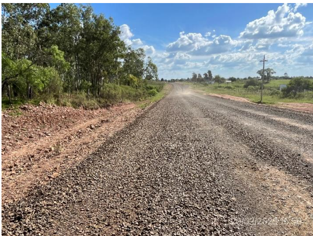
Foto 12.2-3, Ruta 6. Sector con excavación y sub-base granular ejecutadas para ensanche de plataforma.
