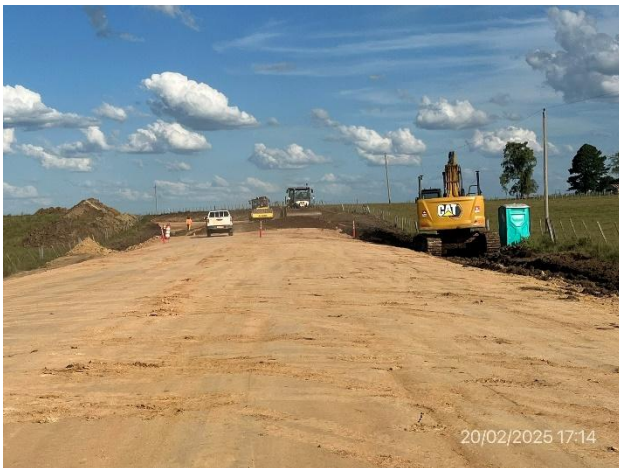
Foto 12.2-9, P05. Frente de obra, tareas de ensanche y recargo granular en ejecución. Baño químico dispuesto en el frente de trabajo.
