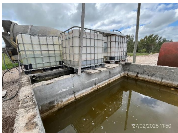
Foto 12.1-11, P03. Pileta de lavado de camiones mixer.
