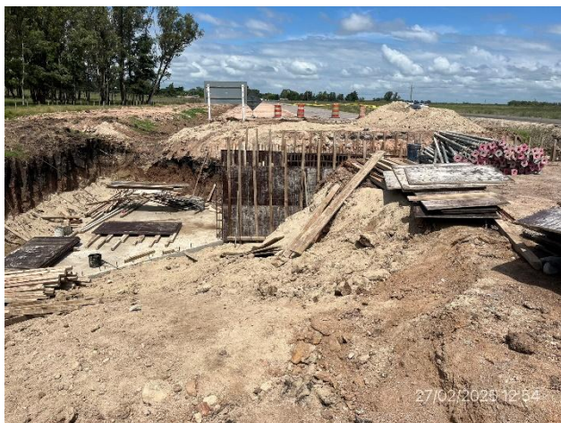
Foto 12.2-5, P08. Se dispusieron equipos e insumos en zona inundable
