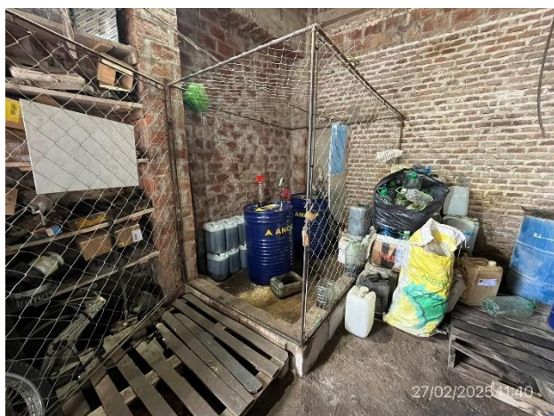
Foto 12.1-9, P03. Taller mecánico, sector envallado de capacidad insuficiente para alojar tarrinas con lubricantes.
