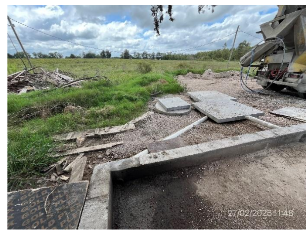
Foto 12.1-12, P03. Lavadero de camiones. La trampa de grasas y aceites no es inspeccionable.
