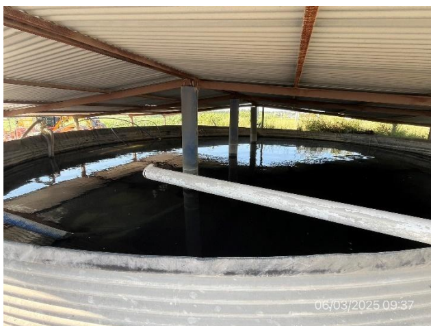
Foto 12.2-3, P03. Planta de hormigón. Tanque australiano con sistema de recuperación
