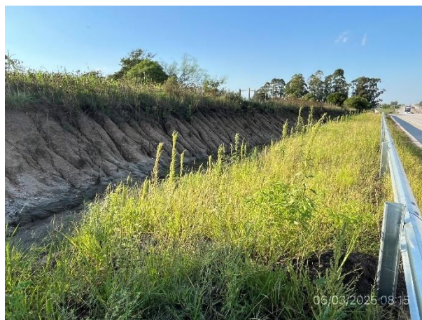
Foto 12.1-6, Ruta 5. Hay erosiones localizadas en contrataludes de cunetas.
