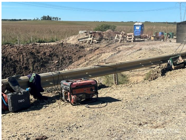
Foto 12.1-7, P05. El generador eléctrico no cuenta con una bandeja para la prevención de derrames.
