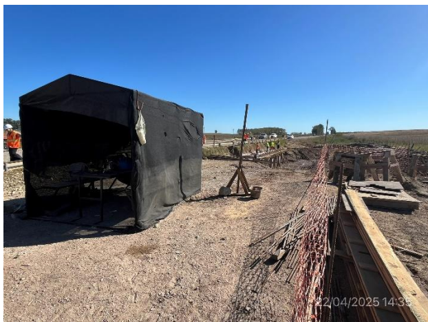
Foto 12.1-5, P05. Campamento provisorio fuera de zona inundable, buenas condiciones de limpieza y orden .
