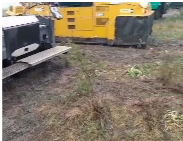
Foto 12.3-2. Ruta 7 progresiva 285K700 a (+), se retiraron todos los restos de suelo con residuos oleosos
