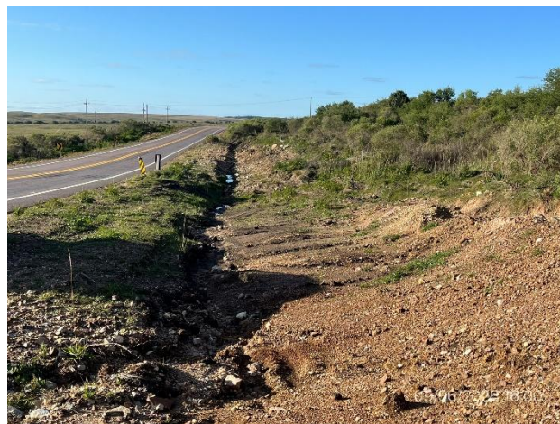
Foto 12.1-4. P06, Ruta 7 progresiva 290K200 a (+). Faja pública con perfilado incompleto de cuneta, expone localmente ese sector a erosiones.
