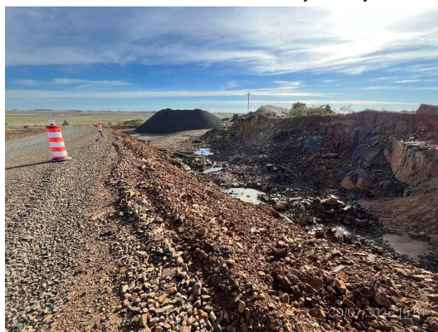
Foto 12.2-22, P07. La nueva traza de la Ruta 6 quedó próxima a una excavación preexistente y se generó un fuerte desnivel.
