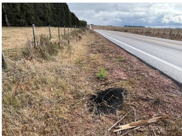
Foto 12.2-5, Faja pública, progresiva 16K000 a (+). Restos de mezcla asfáltica sólida pendientes de retiro y disposición como ROCs.
