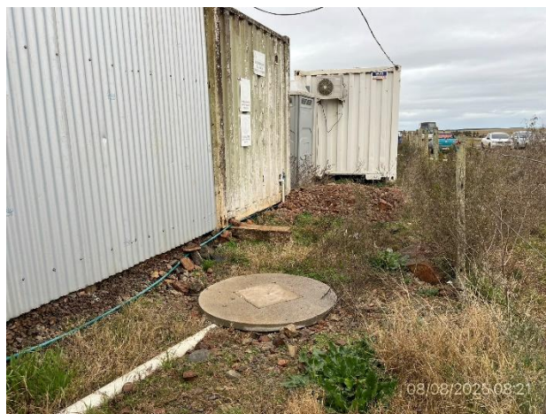
Foto 12.1-6, P03. Obrador, depósito impermeable para desagote de aguas servidas.
