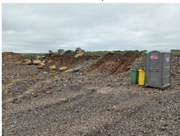
Foto 12.3-3. P03, se colocaron baños químicos en el frente de explotación de la cantera, así como infraestructura para gestión de residuos.
