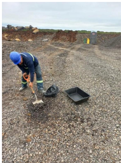
Foto 12.3-2. P03, se recogieron los áridos contaminados con hidrocarburos
