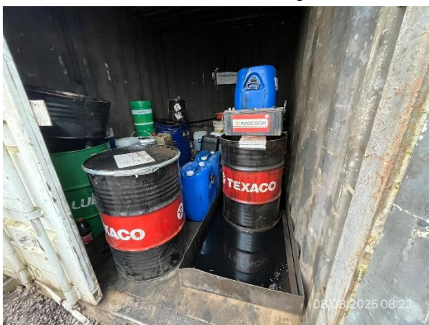
Foto 12.1-3, P03. Depósito cerrado para acopio de lubricantes. Hay tarrinas fuera de las bandejas estancas.
