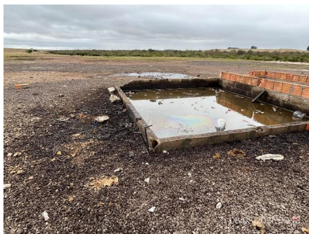
Foto 12.1-18, P04. Obrador. Envallado de aguas oleosas, pendiente de demoler y de disposición final de residuos peligrosos.
