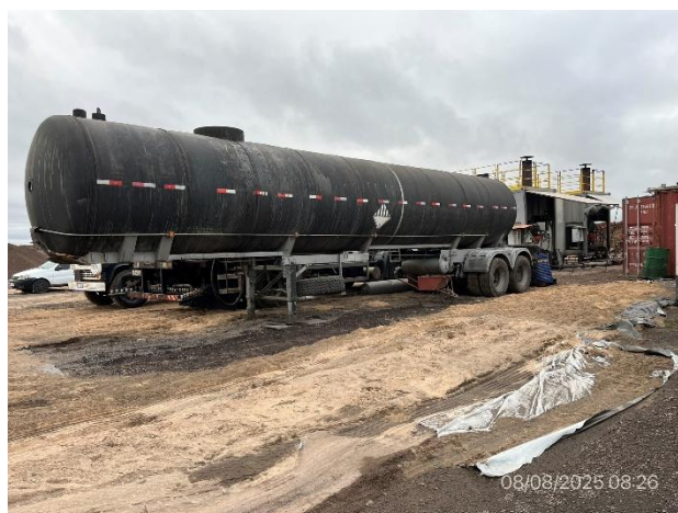
Foto 12.1-8, P03. Planta asfáltica, la cisterna de asfalto se emplazó en zona sin envallado perimetral
