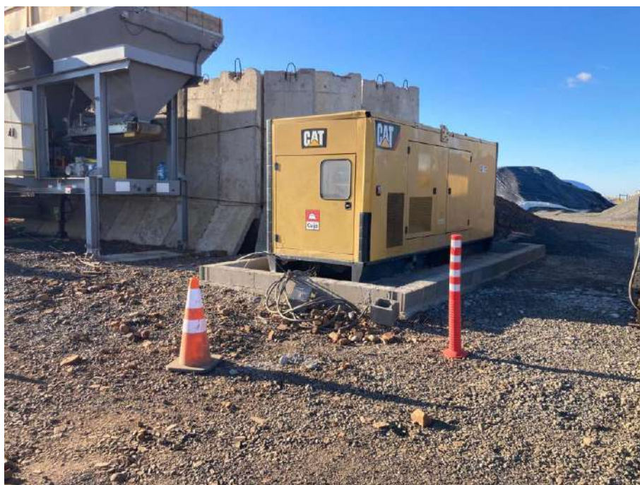
Imagen N°6: Bandeja para el generador de la planta asfáltica.
