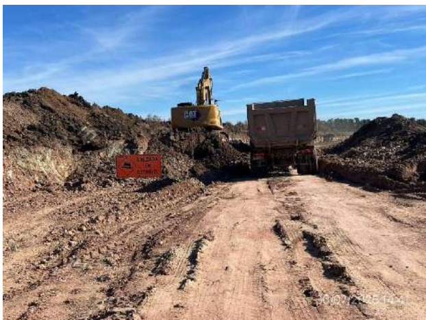
Foto 12.2-9, P05. No se instaló un campamento móvil con servicios de bienestar e infraestructura para el acopio temporal de residuos.
