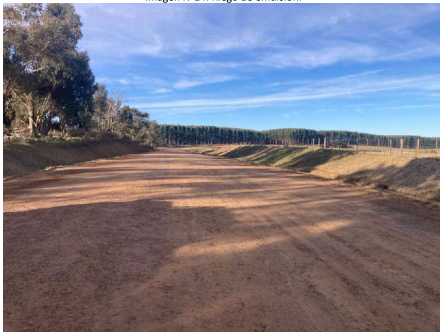
Imagen N°15: Subbase. Taludes con crecimiento de pasto.
