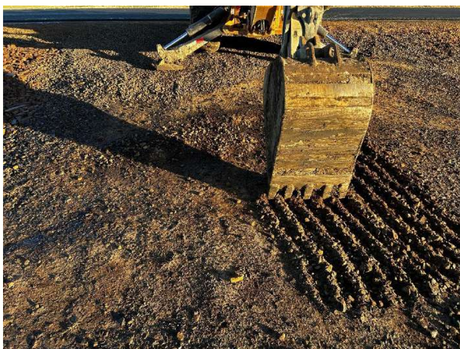
Foto N°1 y 2: Recolección del derrame con retrombinada.
