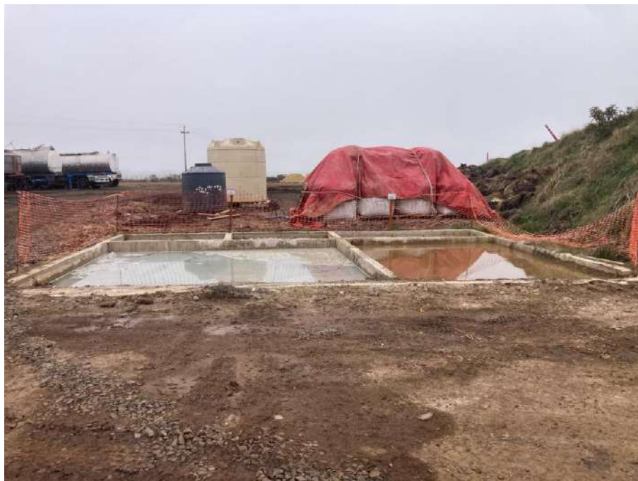
Imagen N°3: Piletas de lavado de mixers y herramientas con hormigón (izquierda) y piletas de efluentes de máquinas y camiones (derecha).
