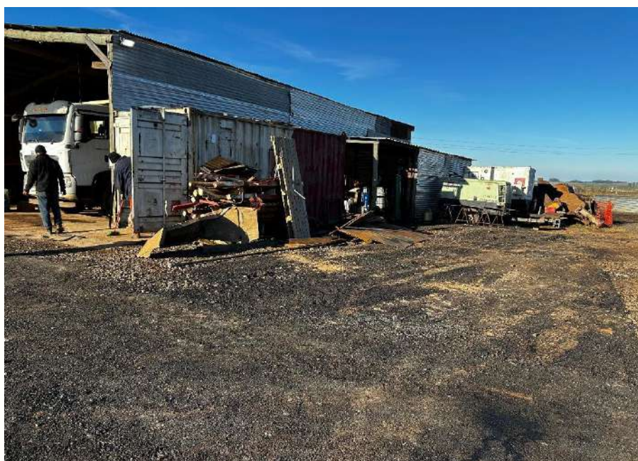
Foto Nº 11 y 12: Zona donde se estaba reparando el camión, y luego de que se movió para adentro del taller mecánico, se evidencia carpeta asfáltica en la zona.
